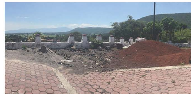
47 Estado actual del mirador.
