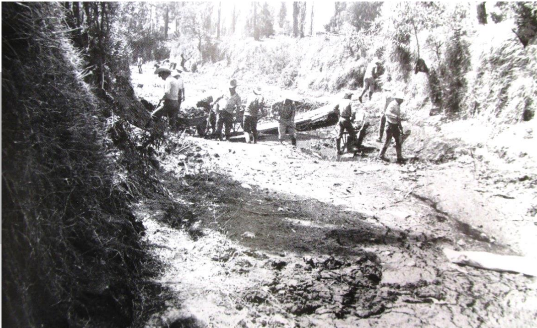
Imagen No. 32. Canal de Santa Cruz (1980). Desazolve para realizar trabajos de limpieza. La imagen puede sugerir el futuro cercano de Xochimilco por la sobre explotación de los mantos acuíferos.
