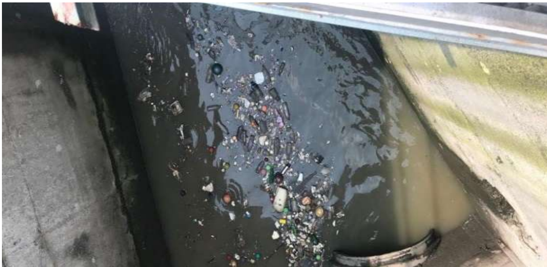
Figura 7. Caja de llegada, ducto superior. Elaboración propia.
