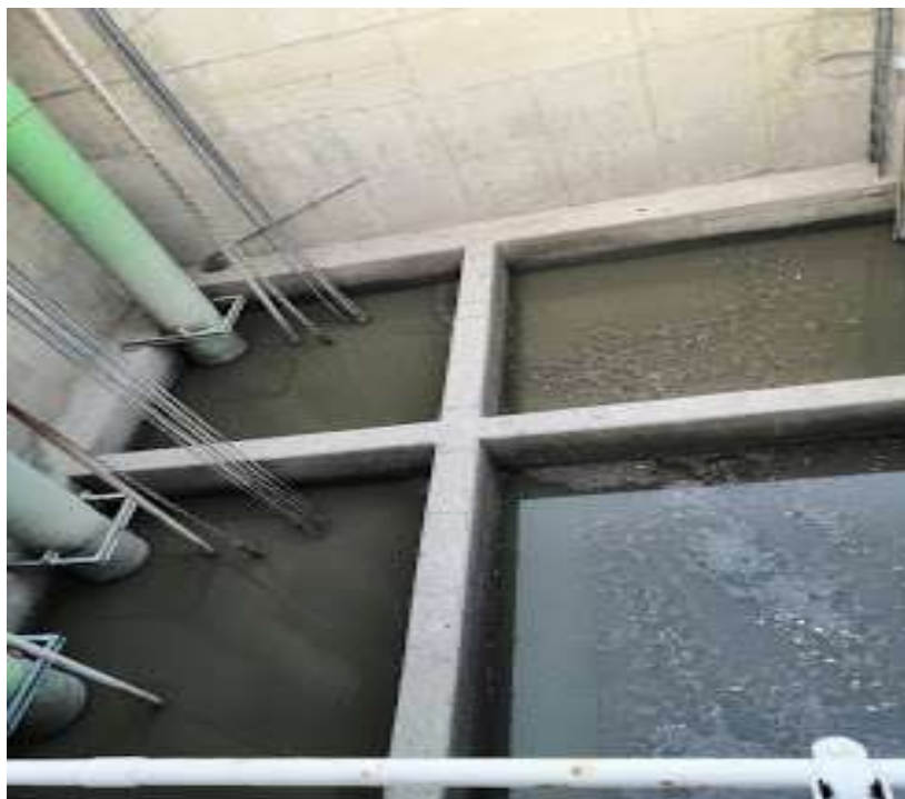
Figura 9. Cárcamo de bombeo. Elaboración propia.
