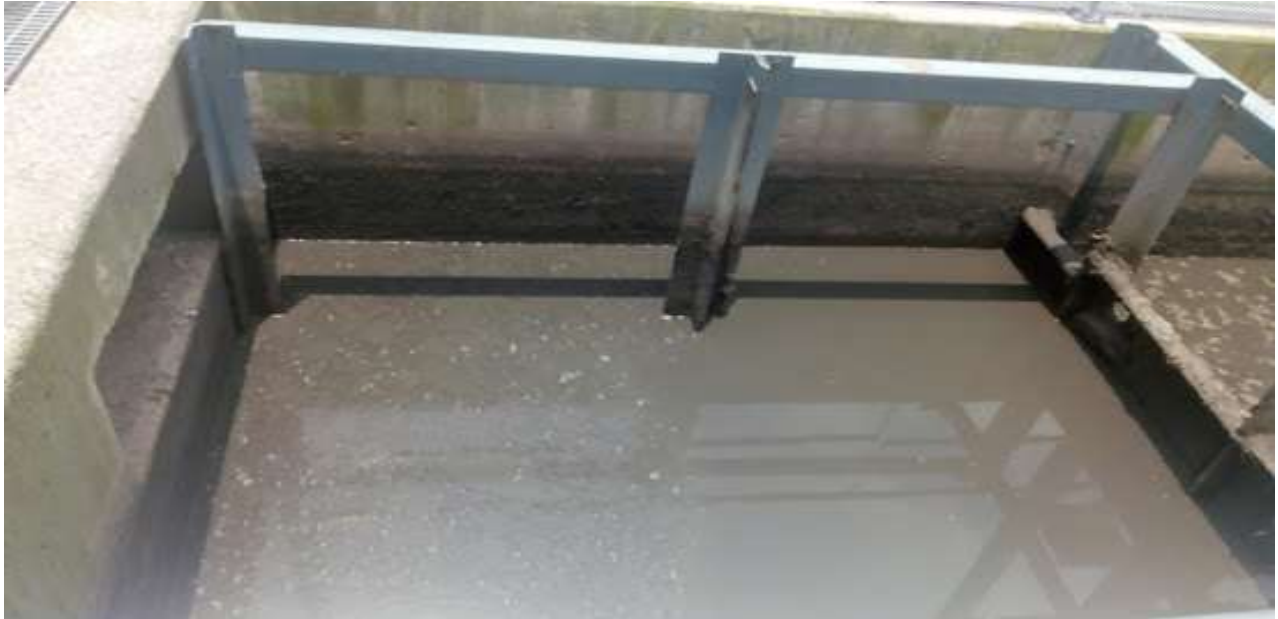
Figura 12. Cárcamo de lodos. Creación propia.
