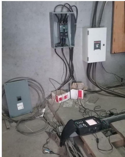
Ilustración 7. Conexión del equipo de monitoreo en la acometida principal
