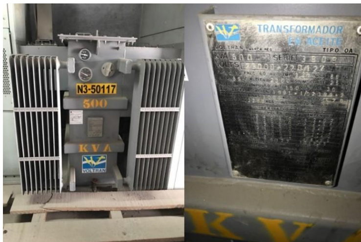
Ilustración 6. Transformador VOLTRAN en aceite. Placa de datos.
