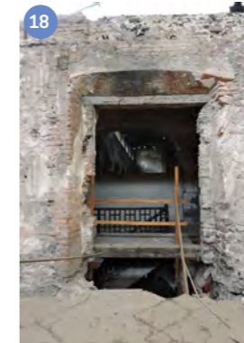
Vista del daño del entepiso y vanos en el local sur
