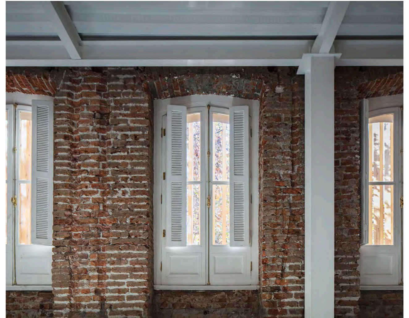
Figura 67. Contraste entre muro original de mampostería y estructura.
