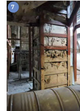
7 Columna reforzada por el deterioro estructural
