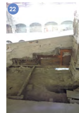
Vista de daño en entepiso y construcción del pretil en la galería poniente
