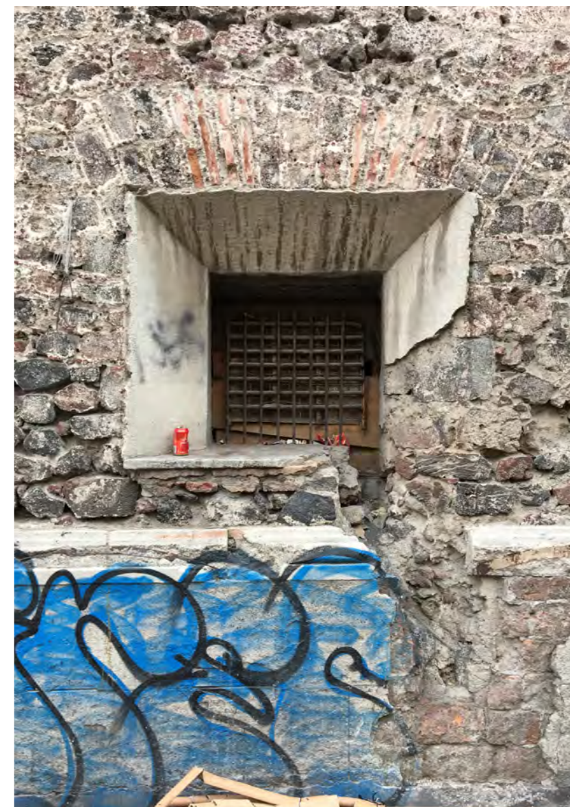
Figura 37. Fotografía de un vano en la fachada oriente, donde las grietas, la diferencia de materiales y grafitis crean una percepción mayor de descuido, 2018, Elaboración propia
