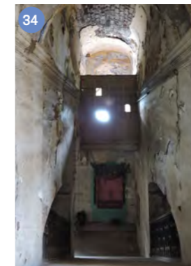
Vista de daño en entrepiso y construcción del pretil en la galería poniente
