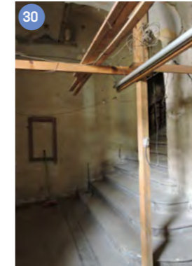
Vista del daño del entrepiso y vanos en el local sur
