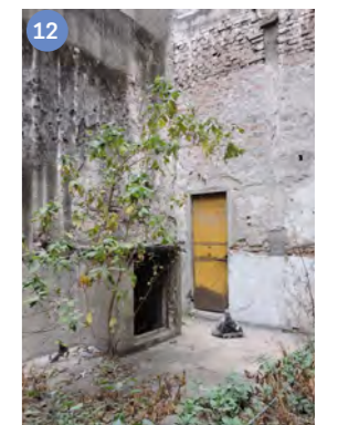
12 Vista del local nor-poniente descubierto e invadido por vegetación
