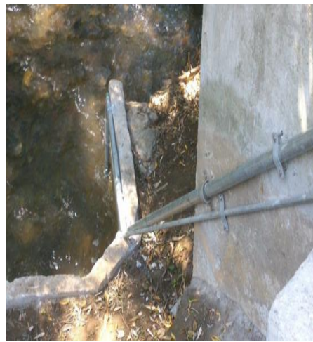
Figura 3.17. Tubería exterior (CONAGUA, 2013)
