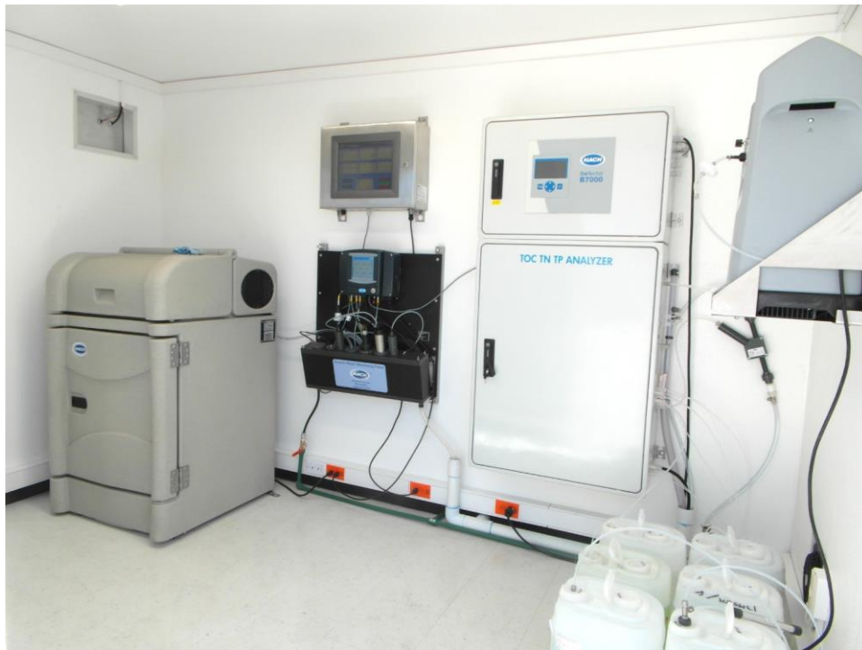
Figura 3.10. Guardian Blue : Interior de la estación automática de medición de calidad del agua (CONAGUA, 2013)
