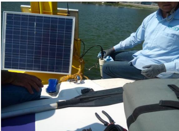
Figura A.2.3. Panel solar de la Boya
