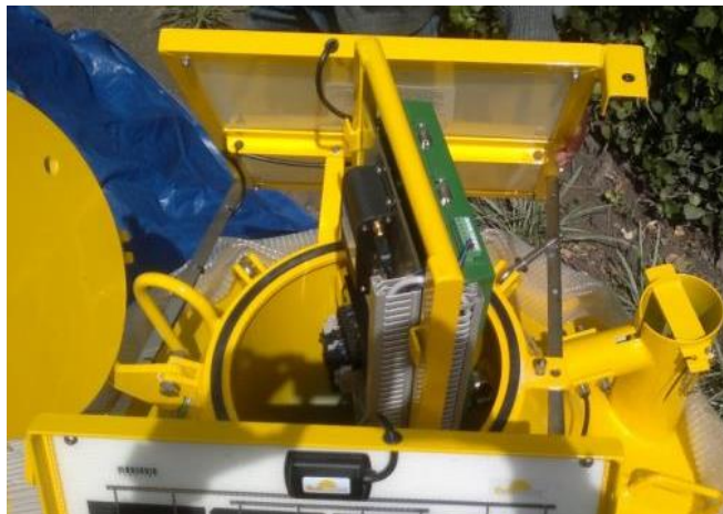
Figura 3.8 Tablero de modem (CONAGUA, 2013)
