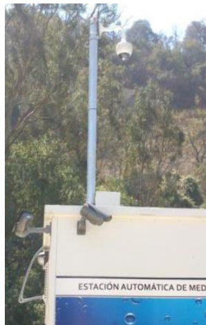
Figura 3.19. Cámaras de vigilancia externas (CONAGUA, 2013)
