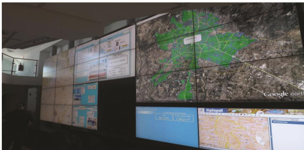
Foto 3.1 Centro de Monitoreo y Control Sapal (Video Muro)
