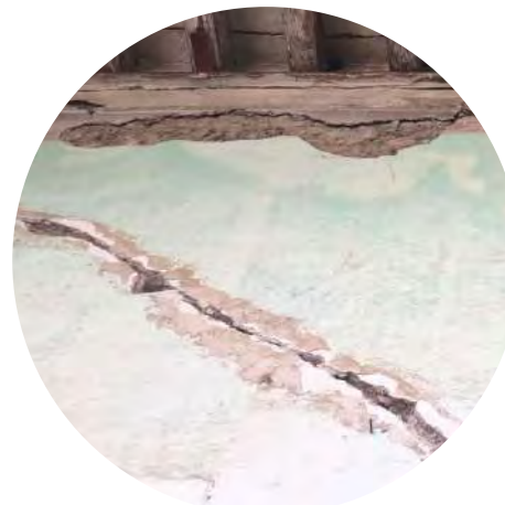
Fisuras en aplanado de muro de adobe; desprendimiento de aplanado
