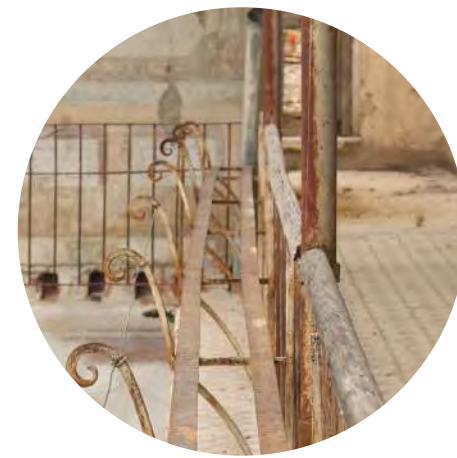
Oxidación en barandal de hierro Presencia de insectos xilófagos en recubrimiento de madera existente sobre barandal
