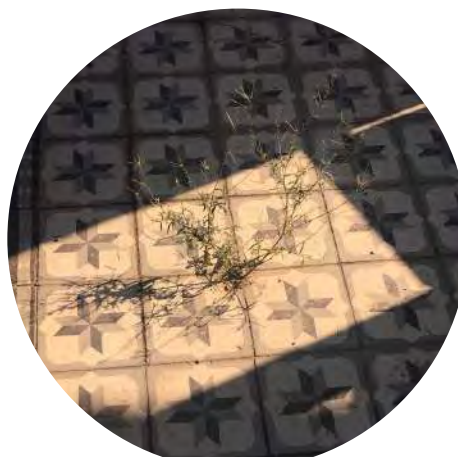
Presencia de flora parásita en baldosas de planta alta
