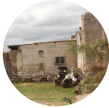
Pérdida de elementos originales, muros adosados con materiales contemporaneos
