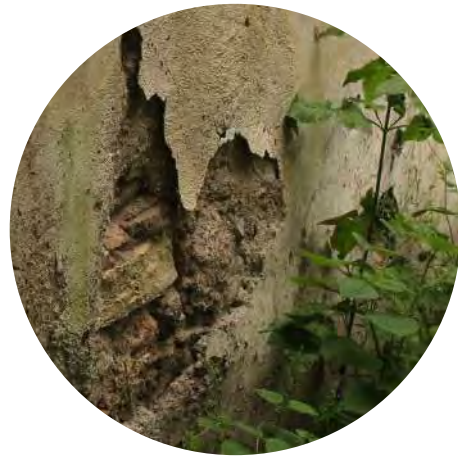
Pérdida de aplanado; agregado de pintura sobre fachada principal. Presencia de humedad asendiendo por muro
