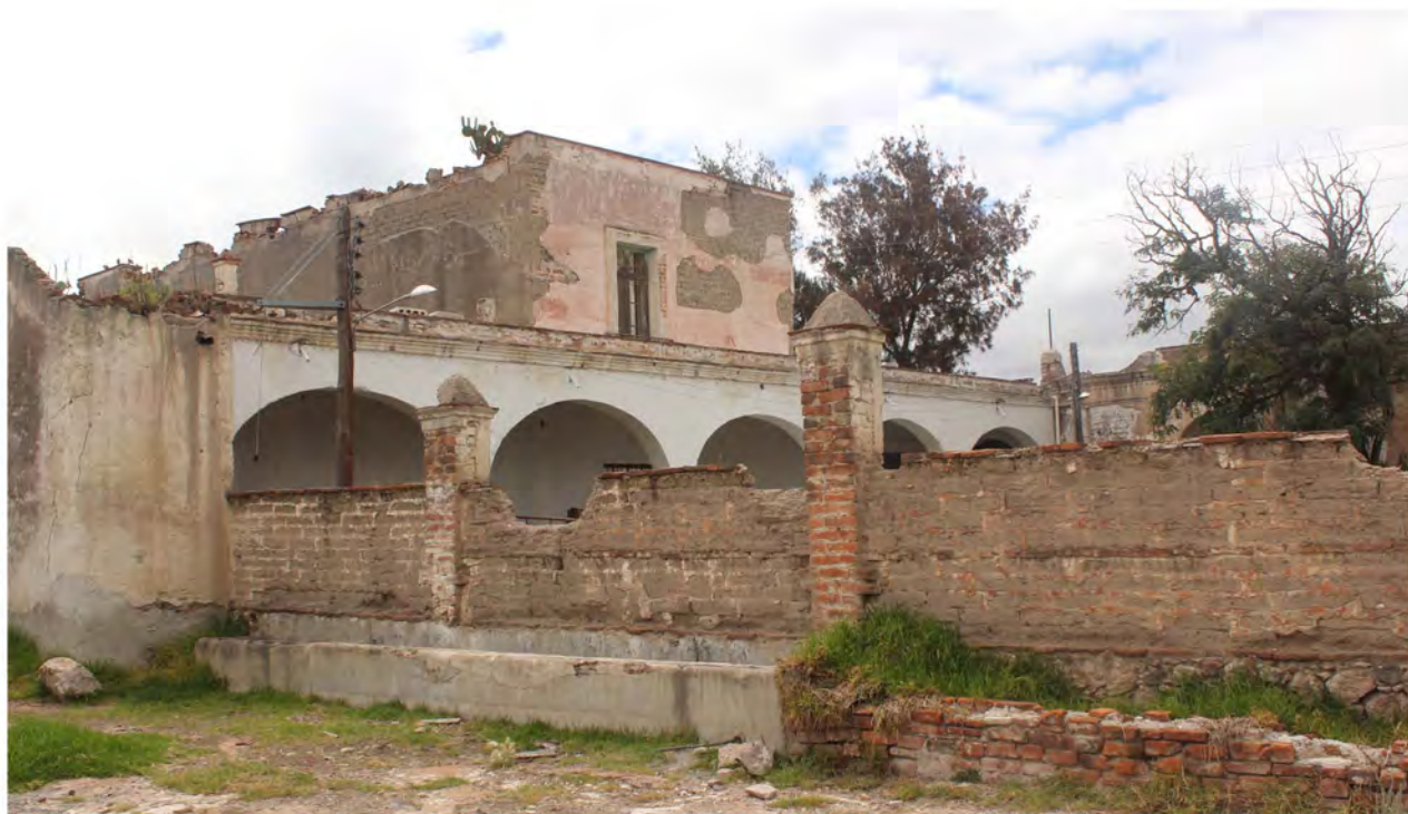
35. Casa del hacendado, estado de conservación. Fotografía del autor, 2018.
