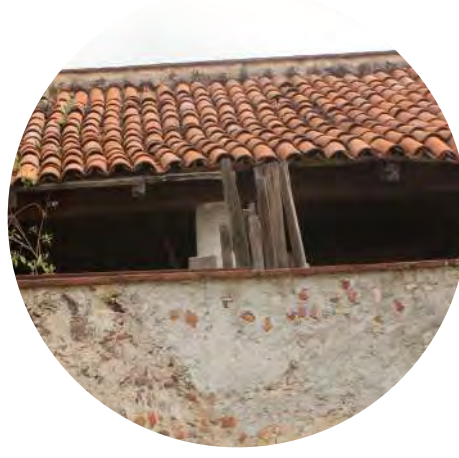
Pérdida de piezas de teja de barro en cubierta de caballerizas (elemento original)
