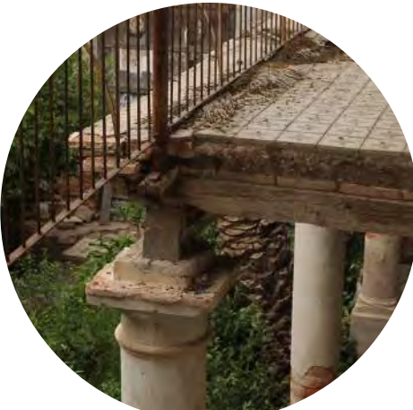
Sistemas de entresijos colapsados, al igual que cubiertas
