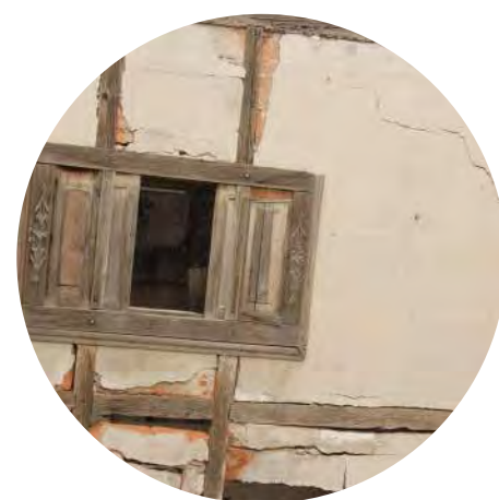
Resqueidad en elementos de madera Pérdida de aplanados y estabilidad estructural en muros de planta alta
