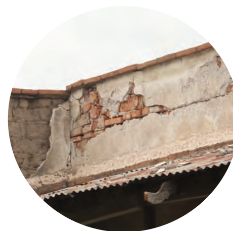
Pérdida de aplanado en muros de tabique, adobe
