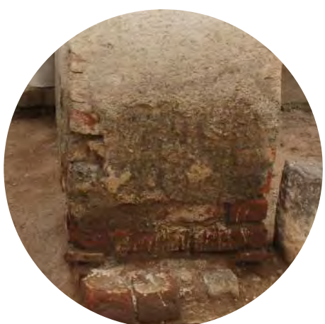
Presencia de humedad ascendente en muros y columnas
