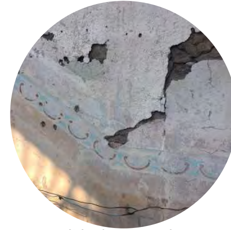
Pérdida de aplanados en muros exteriores; presencia de pintura mural
