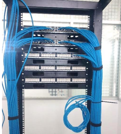
Figura 1-12 Conexiones en patch panel (propia)
