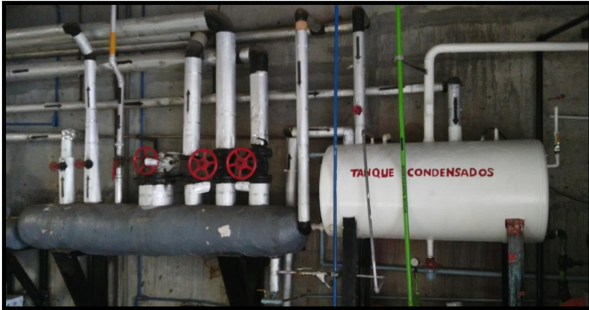
Imagen 4: Tanque de condensados
