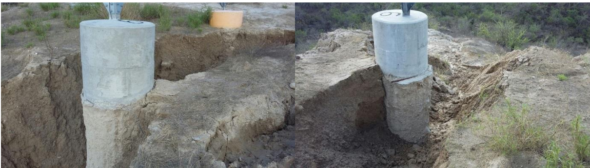
(15).- Torre Suspensión N° 06, SNT-73140-ASJ – (115 Kv):
