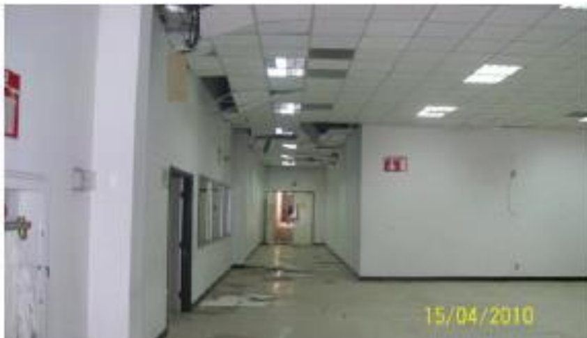
Fuente: Tomadas en campo durante la inspección a las instalaciones afectadas (2010).
