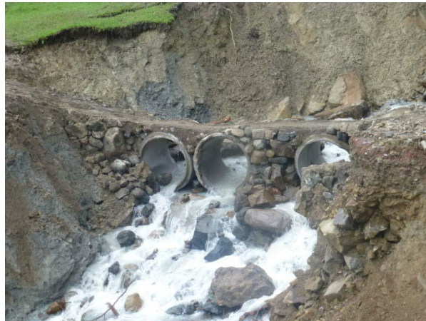
Asentamiento de camino y daño a alcantarillas.
