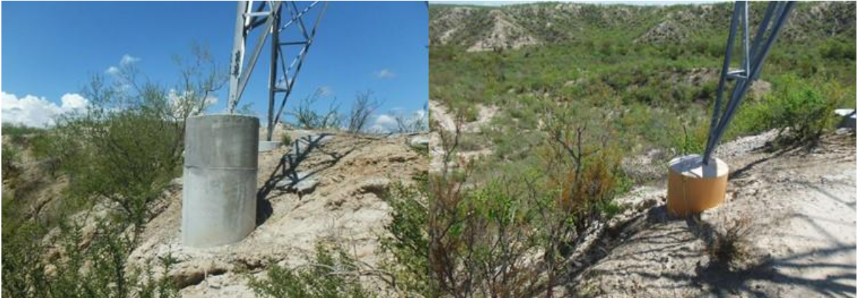
(16).- Torre Suspensión N° 09, SNT-73140-ASJ – (115 Kv):
