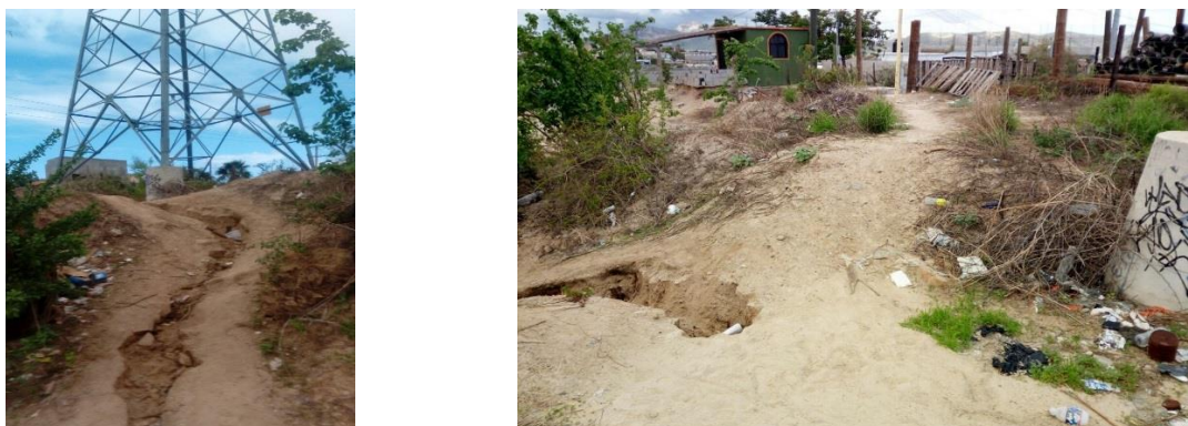
(18).- Torre de Remate N° 03, SJC-73440/220/ELP – (115 Kv):
