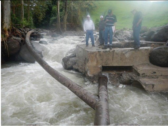
Daño a caja de captura.
