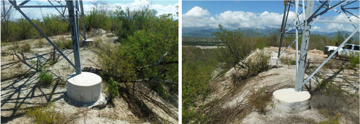
(13).- Torre Suspensión N° 292, OLA-93130/93140-ELP – (230 Kv):
