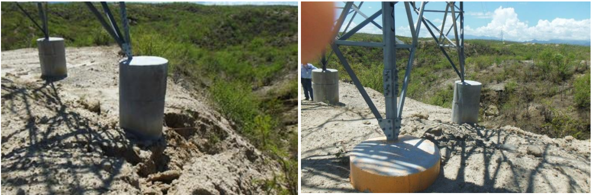
(17).- Torre Suspensión N° 13, SNT-73140-ASJ – (115 Kv):
