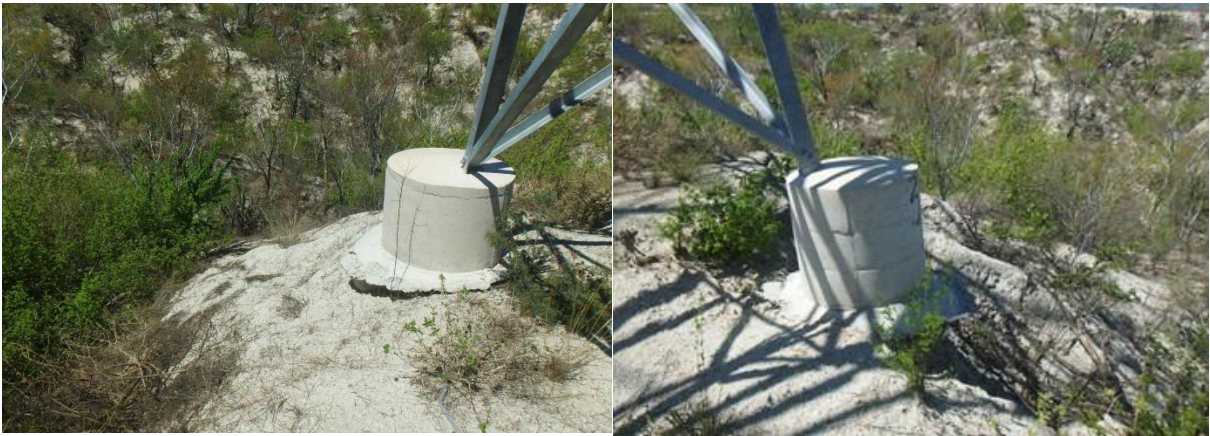
(14).- Torre Suspensión N° 293, OLA-93130/93140-ELP – (230 Kv):
