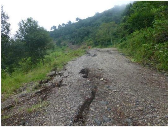
Daño a caminos por pérdida de materiales.
