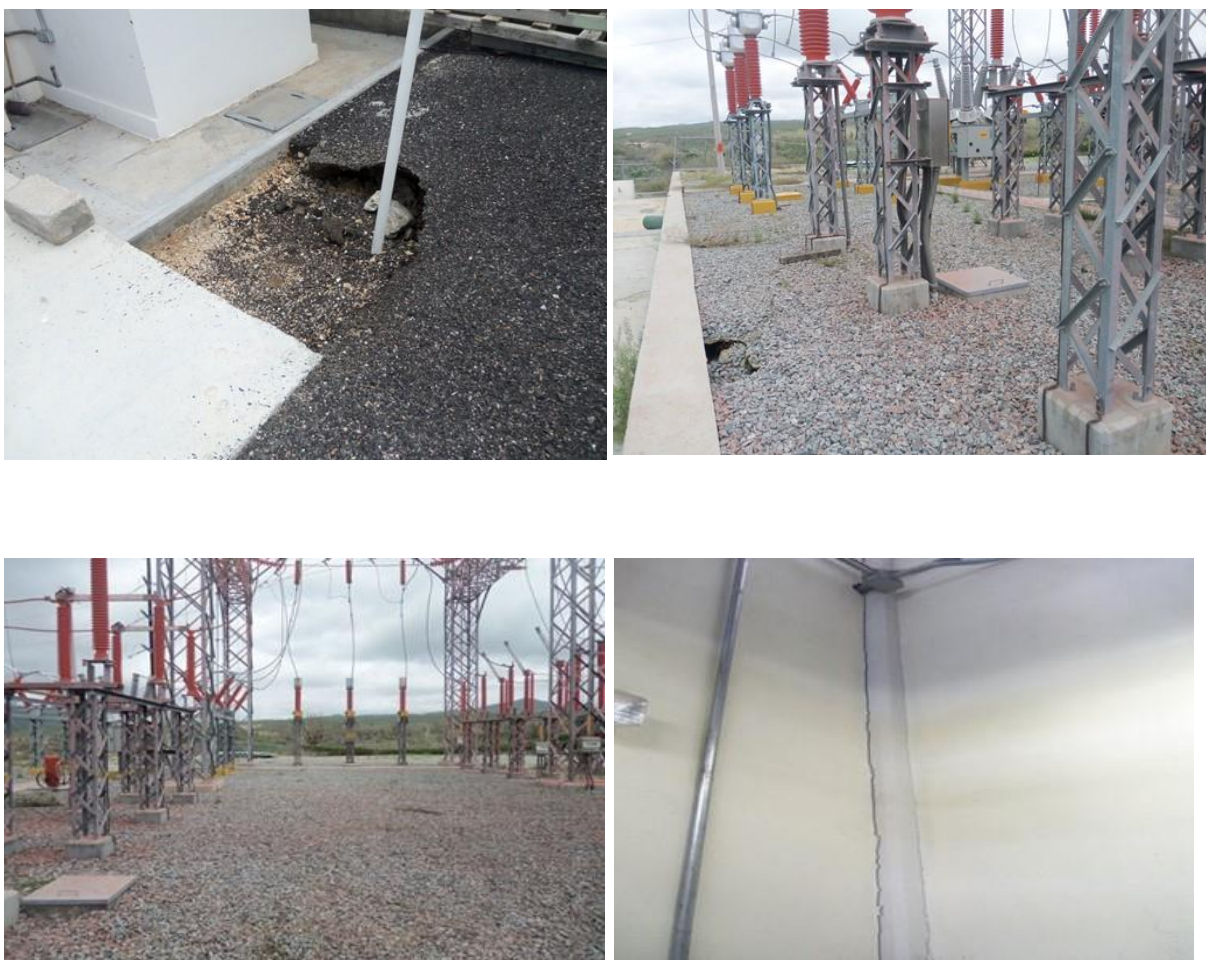
(12).- S.E. Turbo Gas Los Cabos – (TCB):
