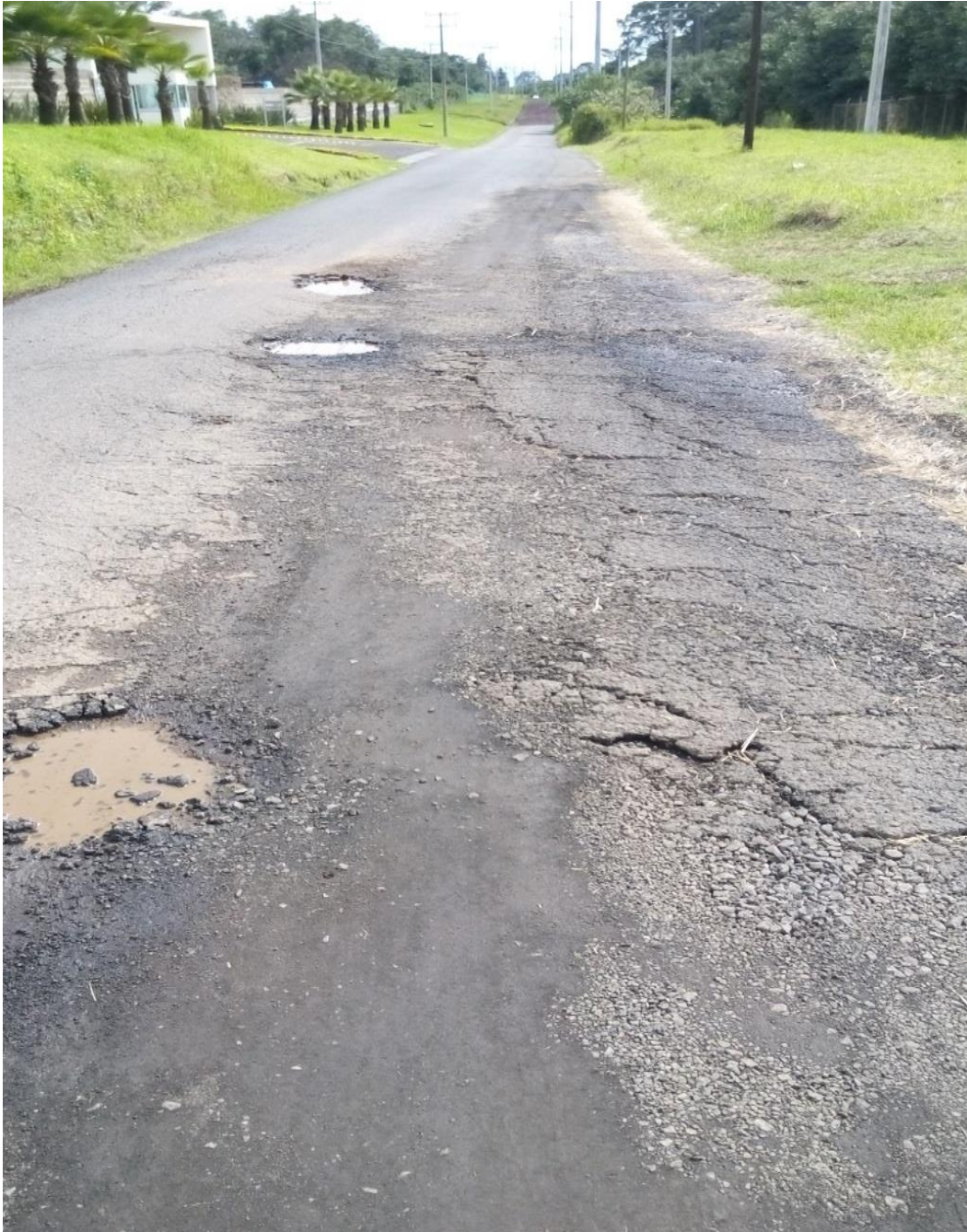
Imagen 3.7.- Carpeta asfáltica en mal estado.
