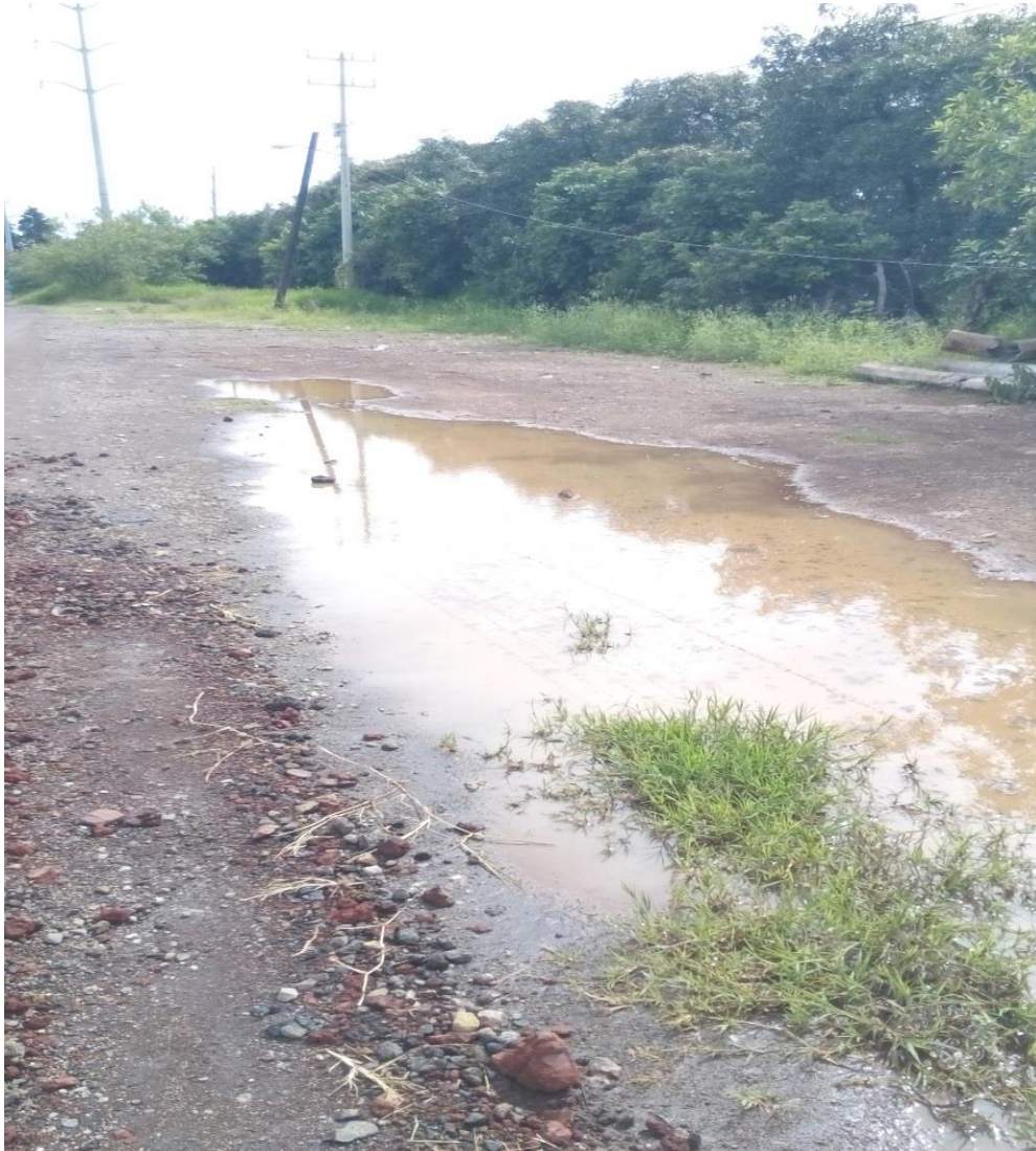
Imagen 3.11.- Camino de terracería con problemas de encharcamiento.
