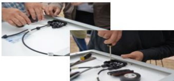
Figura 44. Arreglo de cables
