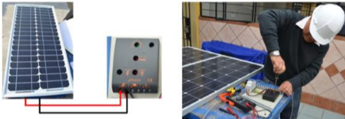
Imagen 14. Conexión de regulador de carga al panel
