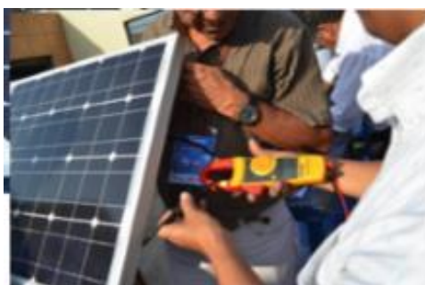
Imagen 17. Medición de panel con multímetro
