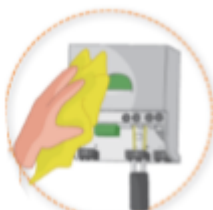
Figura 48. Verificación del regulador de carga
