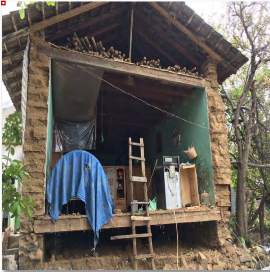
Imagen 19. Vivienda Afectada por sismo 17S en San Juan Ixtoyoapan. Fuente: Eduardo Torres
