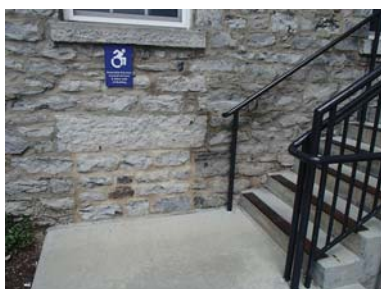
Imagen 99. Escalera exterior con aviso de que la rampa se encuentra del otro lado del edificio. Universidad de Buffalo, NY, EUA.
