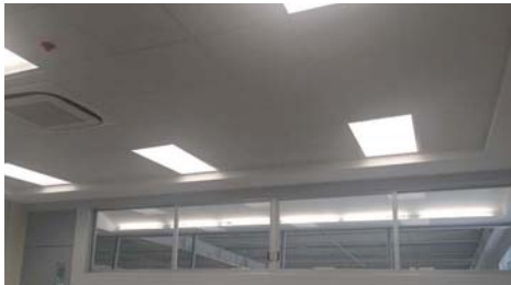
Imagen 263. Luminarias generales del salón, y luz indirecta que entra del pasillo.
