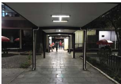
Imagen 62. Pasillo con desniveles y reflejo de las luminarias que pueden causar problemas en su uso. Foto: Martín Vázquez, ESCA, Casco de Sto. Tomás.
