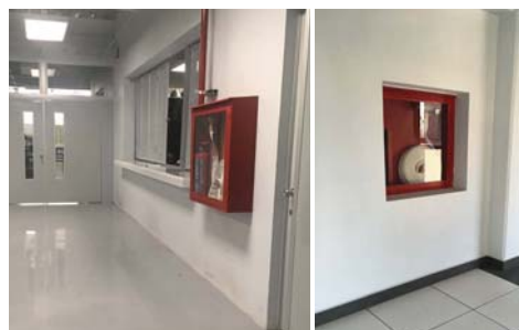
Imagen 277 y 278. Extintores y sistemas de manejo de incendios.
