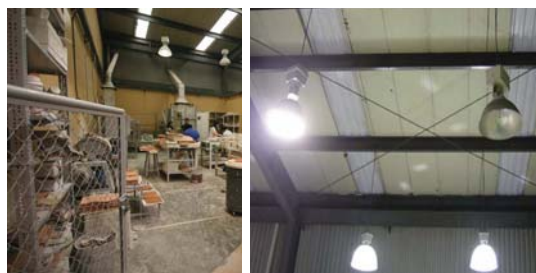
Imagen 182. Es necesario hacer limpiezas constantes como mantenimiento preventivo, aunque esto es complicado debido a la altura del techo.
