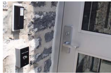
Imagen 84. En la puerta no se utiliza botón para apertura automática sino sensor de movimiento, sin embargo en algunas ocasiones requiere del uso de tarjeta para poder activar la puerta. Universidad de Buffalo, NY, EUA.
