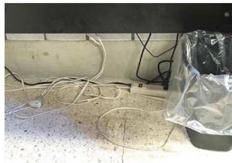
Imagen 135. Contactos obstruidos por mobiliario que generan la necesidad de utilizar multicontactos y extensiones. UAM Xochimilco
