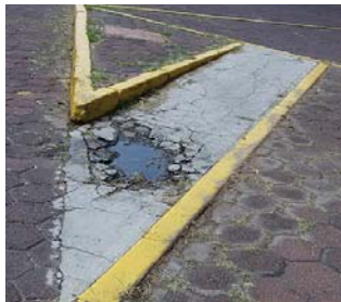
Imagen 33. Rampa con pavimento en mal estado que no permite el paso libre de sillas de ruedas o carriolas. Foto: Juan Miguel Hernández Salgado
