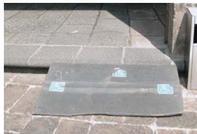
Imagen 26. Rampa portatil en la entrada de una iglesia, la cual se ve desgastada debido a su constante uso.
