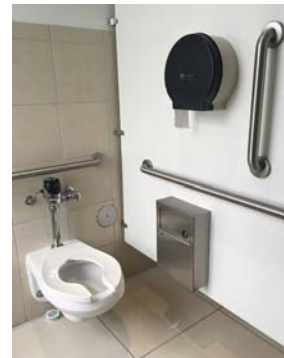
Imagen 57. Los sanitarios con instalaciones adecuadas permiten el uso por parte de todos los usuarios potenciales. Universidad de Búfalo. NY. EUA.
