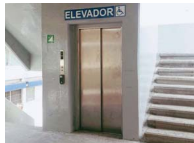
Imagen 109. Elevador angosto pero con control de apertura para evitar el uso por personas que no lo requieren. Foto: Beatriz Hernández, Preparatoria 2, UNAM.
