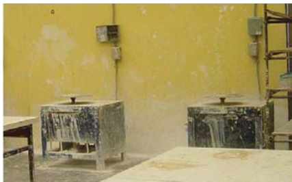
Imagen 189. Las cajas de fusibles se encuentran a la mano y a una altura de 1.5 m.
