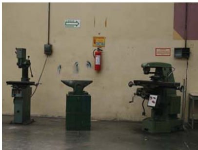
Imagen 188. La señalización, el extintor y la caja de fusibles se encuentran a una altura promedio de 1.5 m, esto permite que se utilicen de manera rápida; sin embargo, no pueden ser utilizadas por personas de baja estatura o en silla de ruedas.
