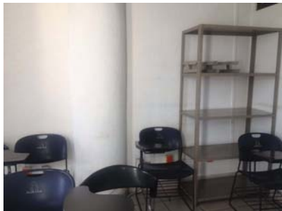
Imagen 128. Los contactos se encuentran detrás del mobiliario y las sillas, siendo de difícil acceso. FFyL, UNAM CU.
