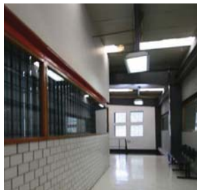
15. Se abrieron huecos en las paredes laterales para mejorar la ventilación, no cuentan con vidrio que proteja en la época de frío.
