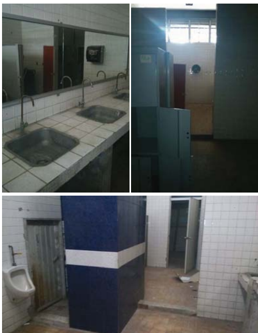
Imagen 207. Condiciones reales de los baños, se encuentran muy descuidados y sin mantenimiento. El sardinel no permite la entrada de silla de ruedas o limita el paso a personas con bastón, andadera o dificultades para caminar. La altura de los lavabos no es adecuada para el uso con silla de ruedas.
