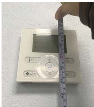
Imagen 269. Control de sistema calefacción y aire acondicionado.
