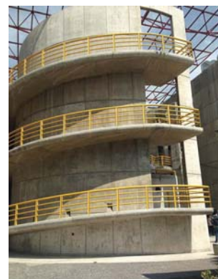
Imagen 193. Edificio de Ciencias Biológicas que integra una rampa como parte estética del diseño arquitectónico pero no es adecuada.
