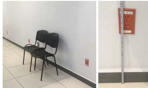
Imagen 252. Serie de tomacorrientes dispuestos en la pared.
