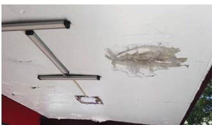
Imagen 68. La falta de mantenimiento en los espacios genera una percepción de descuido y una incomodidad en el uso diario de las instalaciones. Foto: Martín Vázquez, ESCA, Casco de Sto. Tomás.
