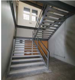
5. Muchos escalones y no hay barandall de los dos lados.
