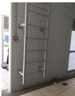
Imagen 246. Escalera volada que puede suponer un riesgo para personas con debilidad visual.
