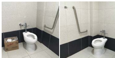
Imagen 262. Barra de apoyo en los sanitarios para PCD, se puede apreciar no hay dispensador de papel a la mano.
