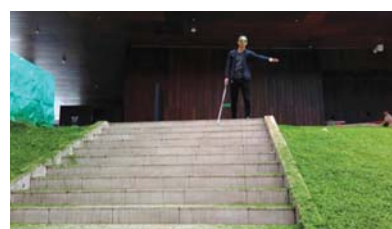
Imagen 100. Escalera exterior sin barandales y con pasto que se convierte en un riesgo para los usuarios. Foto: Ma. Alejandra Barrera, Universidad Tadeo Lozano, Colombia.
