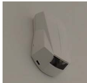
Imagen 66. Señales luminosas para emergencia. Universidad de Buffalo, NY, EUA.
