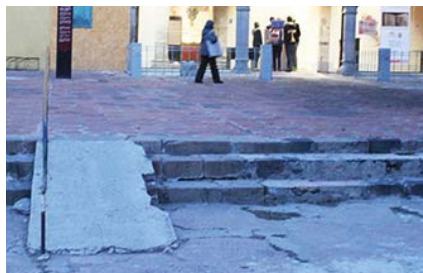
Imagen 28. Rampa construida con el único objetivo de cumplir una función, sin embargo, no cumple los parámetros dimensionales y las pendientes adecuadas.
