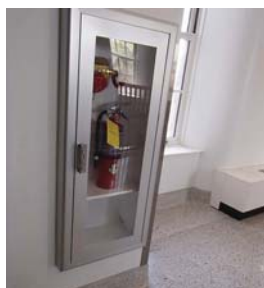
Imagen 158. Extintores dispuestos en la misma área en cada piso. Universidad de Búfalo, NY, EUA.
