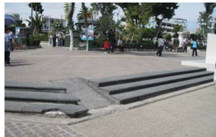
Imagen 29. Rampa integrada en las escaleras ya existentes, la cual puede generar accidentes debido a su disposición y falta de señalización.
