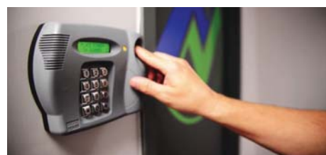
Imagen 194. Ejemplo de un sistema de tarjeta para la apertura de puertas o uso de elevadores. http://www.netrepid.com/wp-content/uploads/2012/10/datacenter3.png
