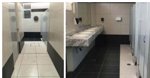
Imagen 254. Textura del piso del sanitario, condiciones de iluminación y coladera dispuesta en un área que permita la salida del agua.
