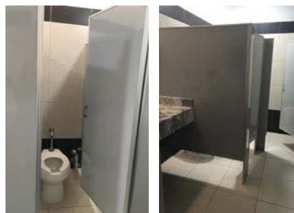
Imagen 255. Apertura de la puerta hacia adentro, lo cual complica la entrada y salida pero previene accidentes.
