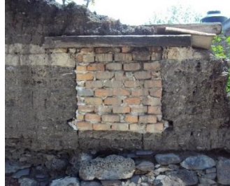
Dintel en ventana tapiada en la casa del Sr. Guillermo Pérez
