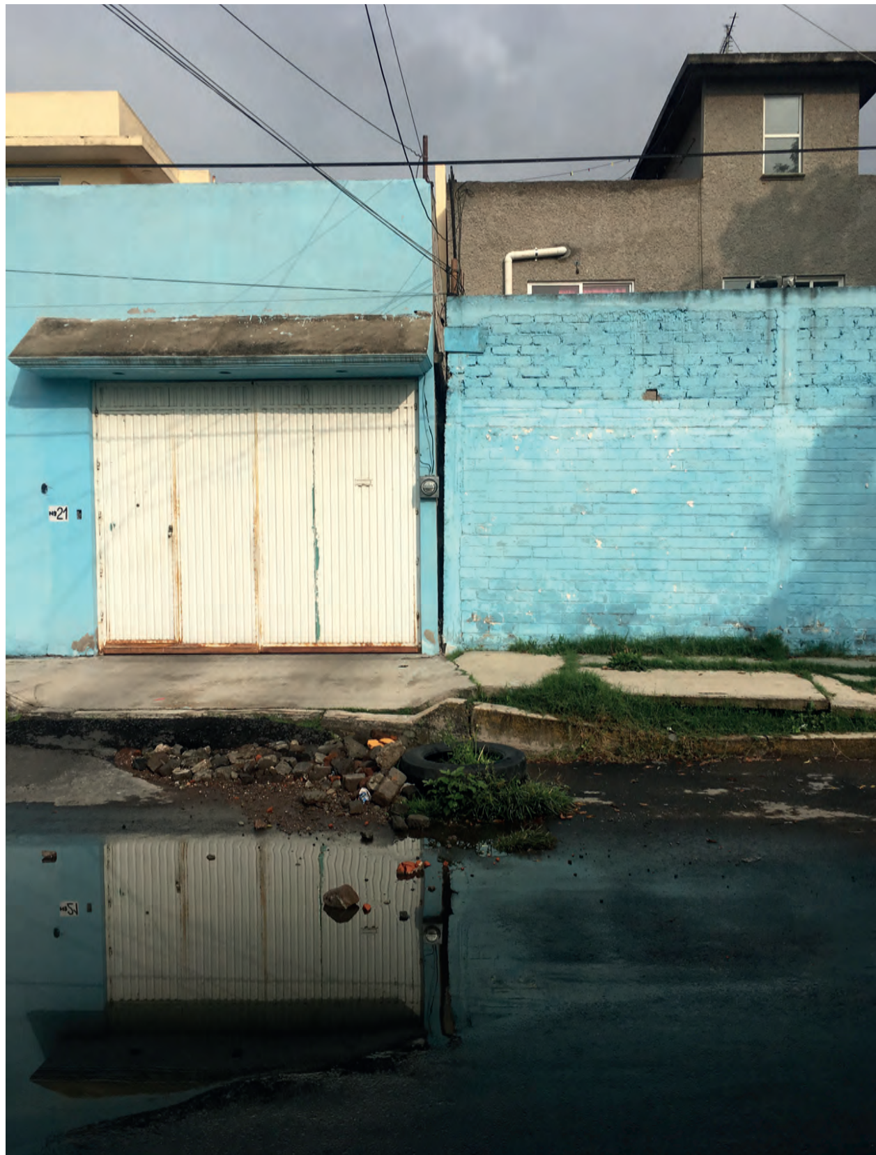
Fig 12. Vivienda con afectación mínima
