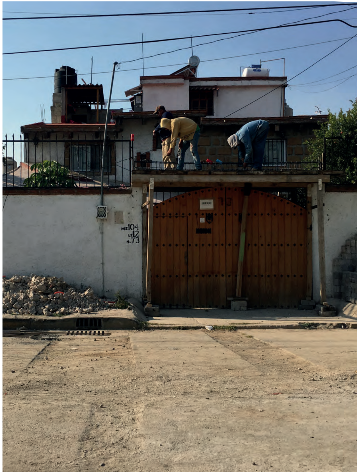
Fig 15. Vivienda con afectación media
