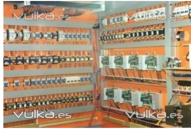
Imagen 59: Cuarto de control eléctrico
