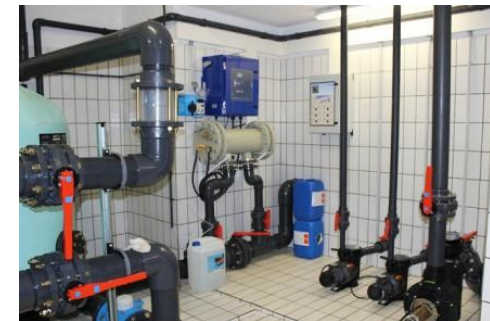
Imagen 37: Instalación hidráulica a base de equipos de bombeo.
