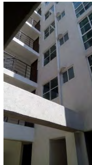
Imagen: 1.10.22 Cubo de ventilación.
