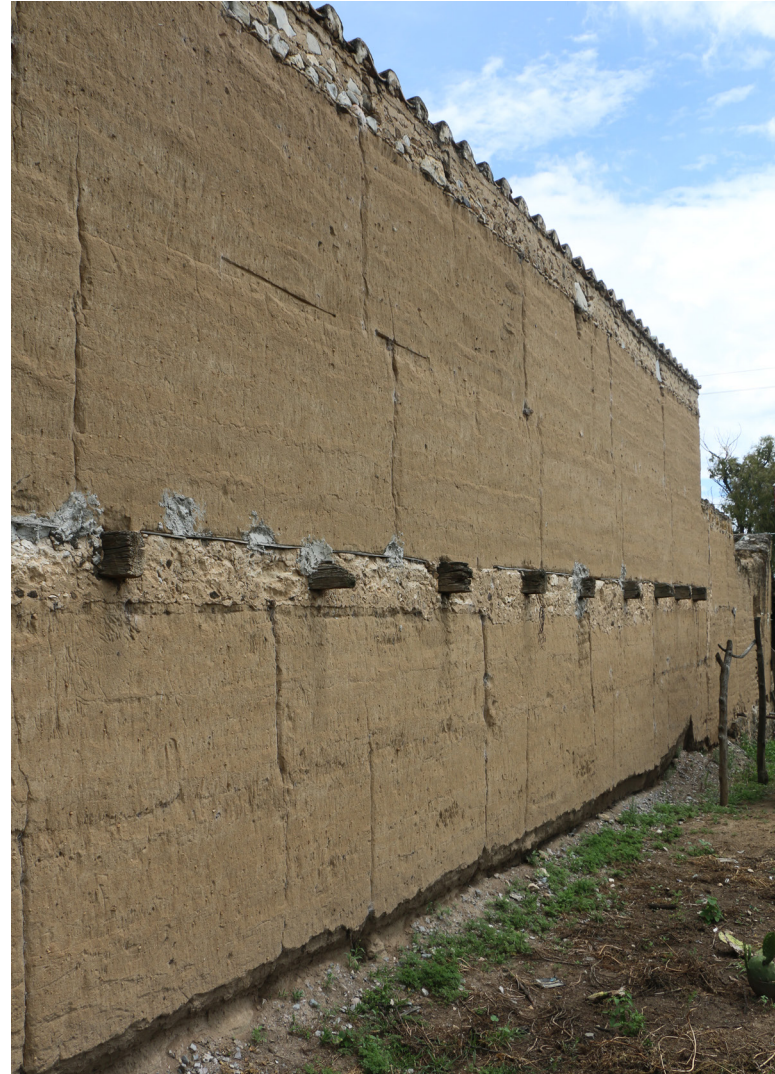
Fig. 32. Muro tradicional de tapia de tierra en San Andrés Payuca, Puebla, México (Fotografía: acervo del LABPySCT)
