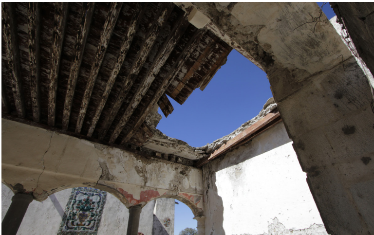
Figs. 42 y 43. Techumbre en ruinas donde puede apreciarse el sistema constructivo de las cubiertas: vigería de madera con una capa de tejamanil y las capas de terrado de piedras volcánicas y cal. (Fotografías: acervo del LABPySCT).
