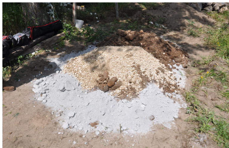
Fig. 74. Materiales de la tapia y mezclado en seco. (Fotografías: acervo del LABPySCT)
