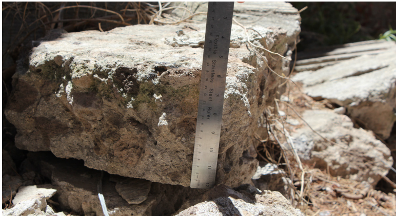
Figs. 46 y 47. En estas imágenes de una construcción cuya cubierta fue demolida, puede apreciarse el espesor de los terrados, que oscila entre 12 y 16 cm (Fotografías: acervo del LABPySCT).
