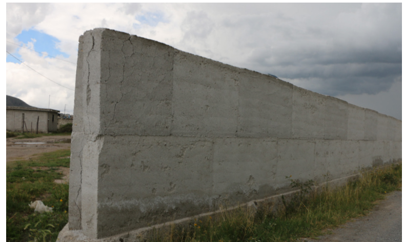
Fig. 157. En la esquina superior de esta tapia puede observarse el fenómeno de “palomeo del muro” (Fotografía: acervo del LABPySCT).
