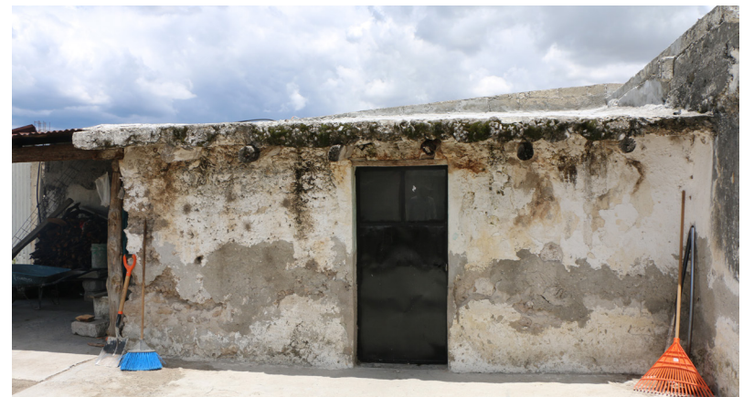
Figura 54. Techo de viguería y entortado de cal y piedra pómez en vivienda de la comunidad de El Fuerte (Fotografía: Acervo del LABPySCT)
