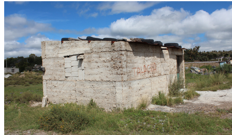
Figs. 85 y 86. En estas imágenes puede observarse el correcto contrapeo de las tapias, en las esquinas, alternando el remate de la esquina entre cada hilada. (Fotografías: acervo del LABPySCT)
