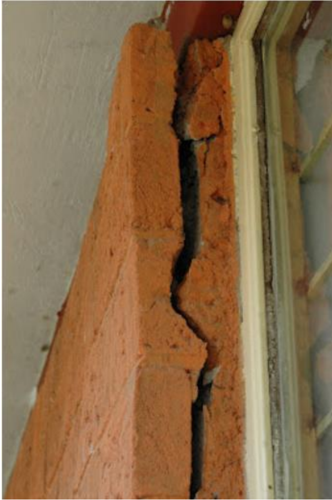
Foto 15. Daños en la fachada del Jardín de niños Lorenzo Filho, unidad habitacional Morelos 3era. Sección, Isla Municipal.
