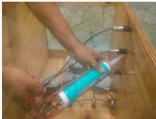
Figura 32. Colocación de sensores de presión
