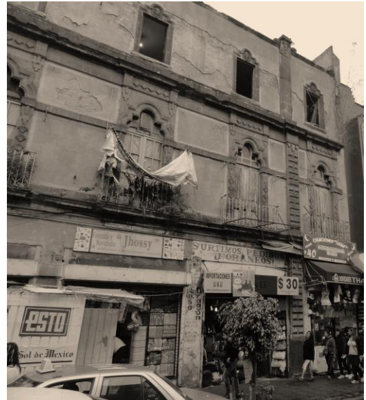
Figura 1.28 Edificio con deterioro. Calle Justo Sierra. Fotografía tomada por la autora, 2015.
