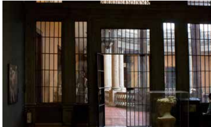
17. Reja de acceso a una de las salas en planta alta. Imagen 117. [Fotografía de Rafael Ramírez]. (CDMX.2017)
