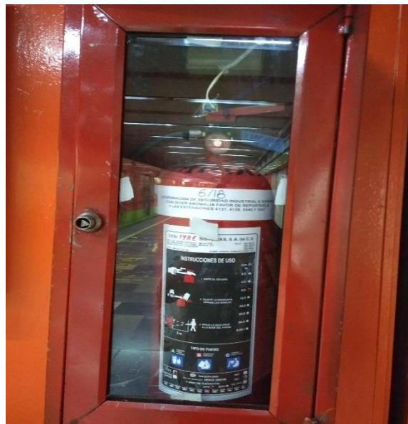
Figura 18. Extintor bajo resguardo.
