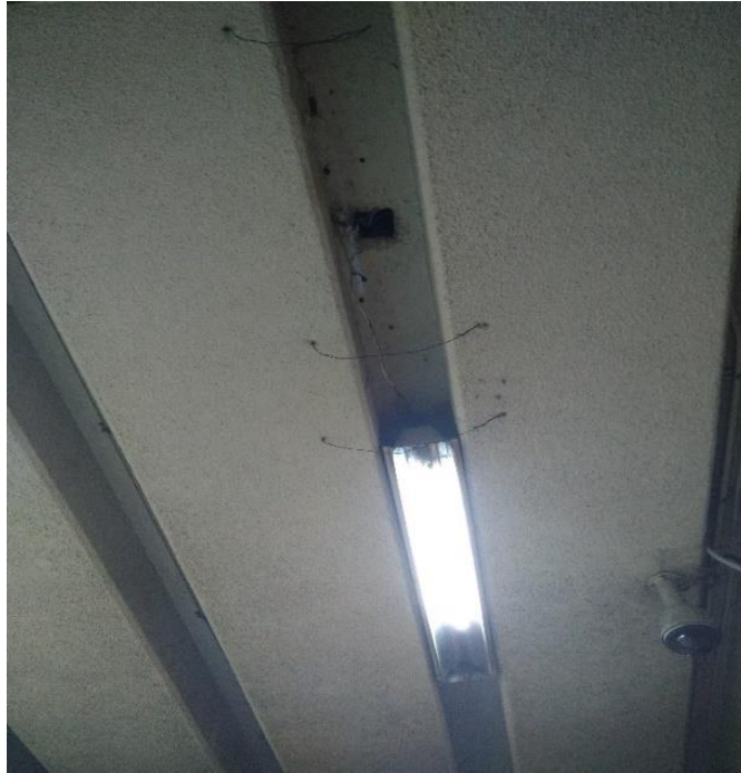
Figura 21. Faltantes de focos en la estación Zapata.
