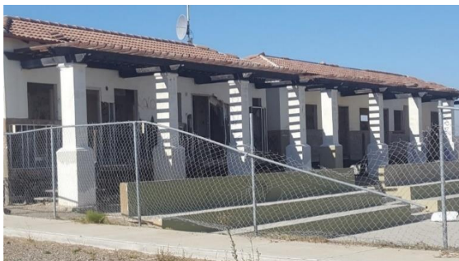
Fotografía 4.6. Centro comunitario abandonado.
