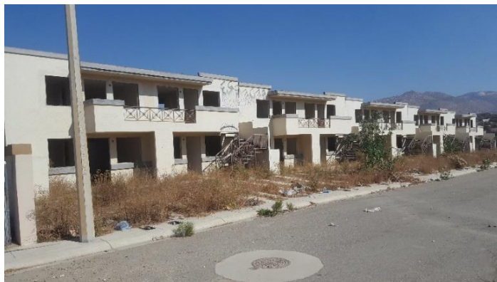
Fotografía 4.13. Vivienda terminada abandonada por el constructor.
