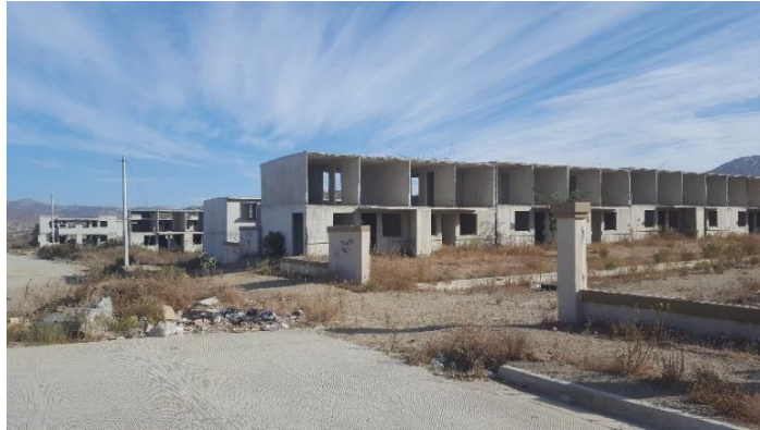
Fotografía 4.11. Vivienda abandonada en etapa de construcción.
