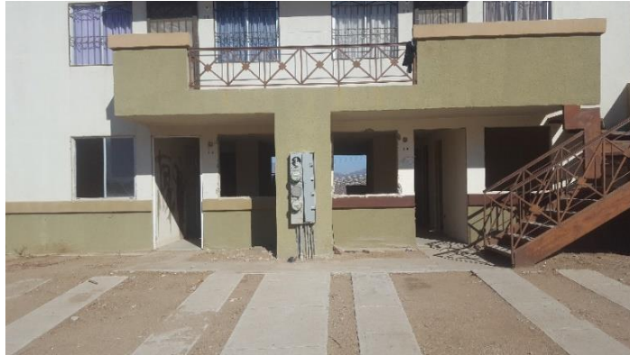
Fotografía 4.14. Vivienda abandonada prototipo Cuádruples.
