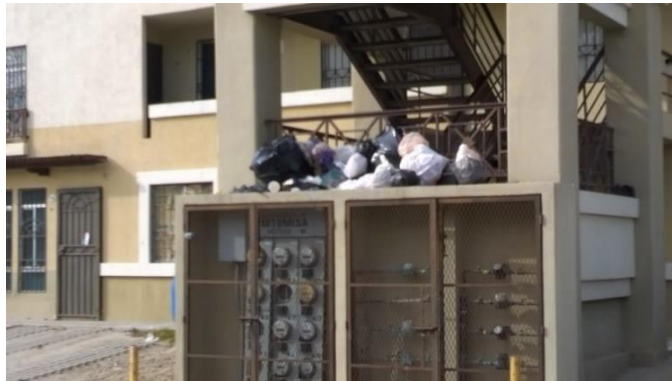
Fotografía 4.9. Basura colocada sobre el concentrador de medidores de energía eléctrica y agua potable al interior de un condominio del prototipo dodecadúplex.
