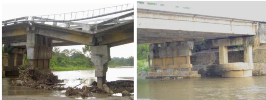
Figura 1.6. Daño parcial del puente Tepuzapa por huracán Stan, Chiapas. Rivera y Núñez (2016)
