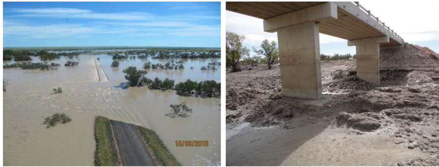
Figura 1.19. Socavación en pilas y terraplenes de acceso del puente Burke and Wills , Queensland, Australia. TMR (2013)
