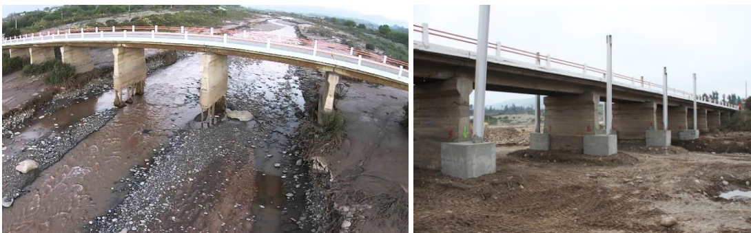
Figura 1.20. Daño por socavación en pilas del Puente Altovalsol, Región de Coquimbo, Chile. Gómez (2016)
