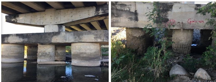
Figura 1.10. Socavación en pilotes del Puente Vado Ancho, Chiapas. IIUNAM (2017)
