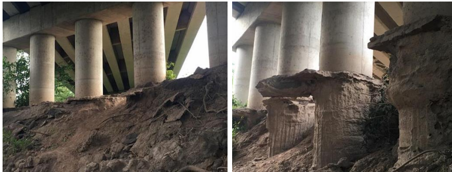
Figura 1.15. Socavación en pilas del Puente Cañas Principales, Nayarit. IIUNAM (2017)
