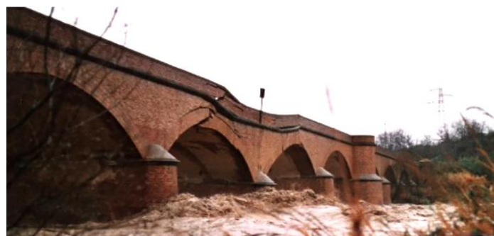
Figura 1.18. Colapso del Puente Río Trigno, Molise, Italia. Zampieri et al (2017)
