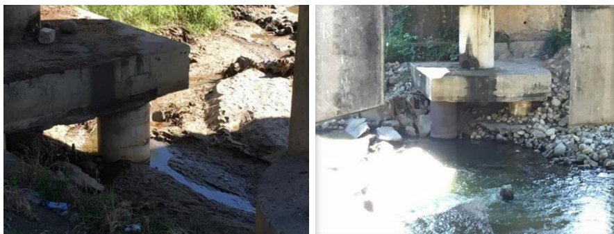
Figura 1.7. Socavación general actual en el Puente Tepuzapa. IIUNAM (2017)
