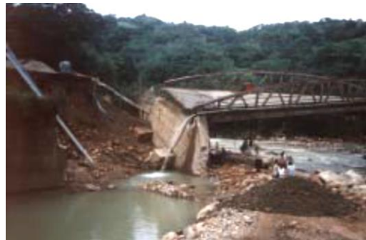
Figura 1.17. Falla de estribo del Puente Unete, Casanare, Colombia. Muñoz (2002)
