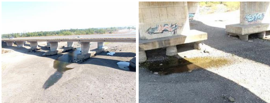
Figura 1.13. Socavación en pilotes del Puente Ignacio Chávez, Michoacán. IIUNAM (2017)
