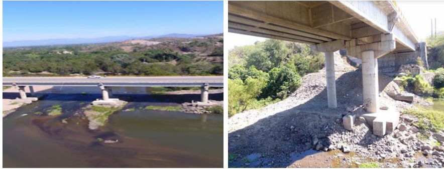
Figura 1.14. Socavación general en el Puente Tomatlán, Jalisco. IIUNAM (2017)
