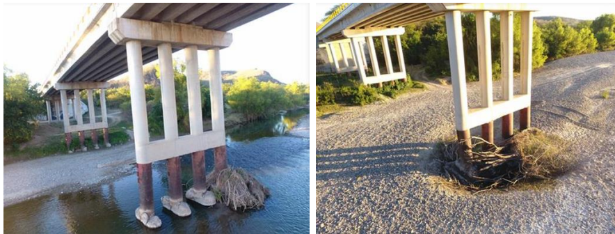
Figura 1.16. Socavación de hasta 3 m en pilas del Puente Piaxtla Libre, Sinaloa. IIUNAM (2017)
