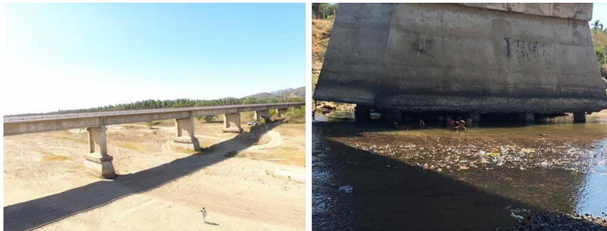
Figura 1.12. Socavación total de más de 4 m en el Puente Río Nexpa, Guerrero. IIUNAM (2017)
