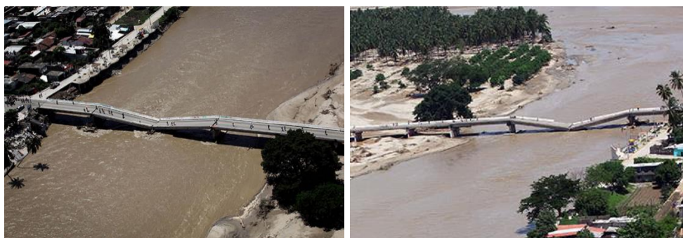
Figura 1.9. Colapso del Puente Coyuca, Guerrero. Excelsior (2013)
