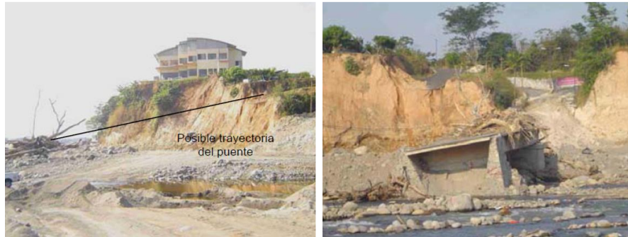
Figura 1.5. Colapso total del Puente Coatán por huracán Stan, Chiapas. Rivera y Núñez (2016)
