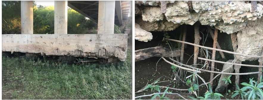
Figura 1.11. Socavación en cimentación del Puente Río Los Perros, Oaxaca. IIUNAM (2017)
