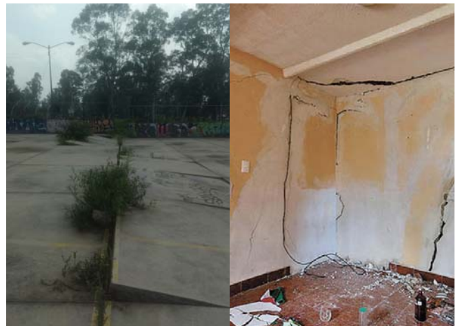
Tanto viviendas como espacios públicos abiertos y equipamientos dentro de la Unidad Habitacional Villa Centroamericana sufrieron daños causados por el sismo del 19 de septiembre.
