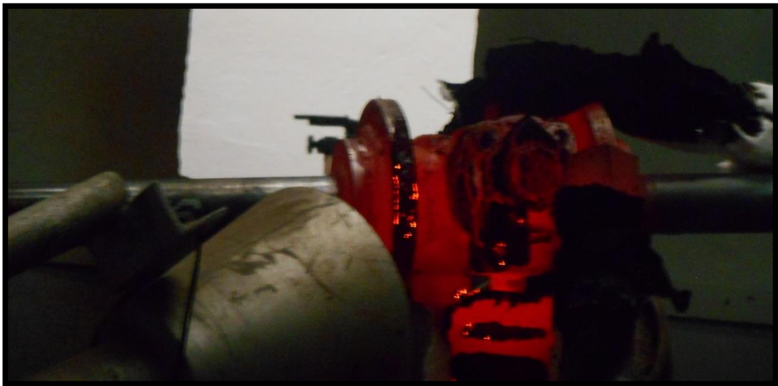
Figura 4.10 "Válvula después de la prueba"
