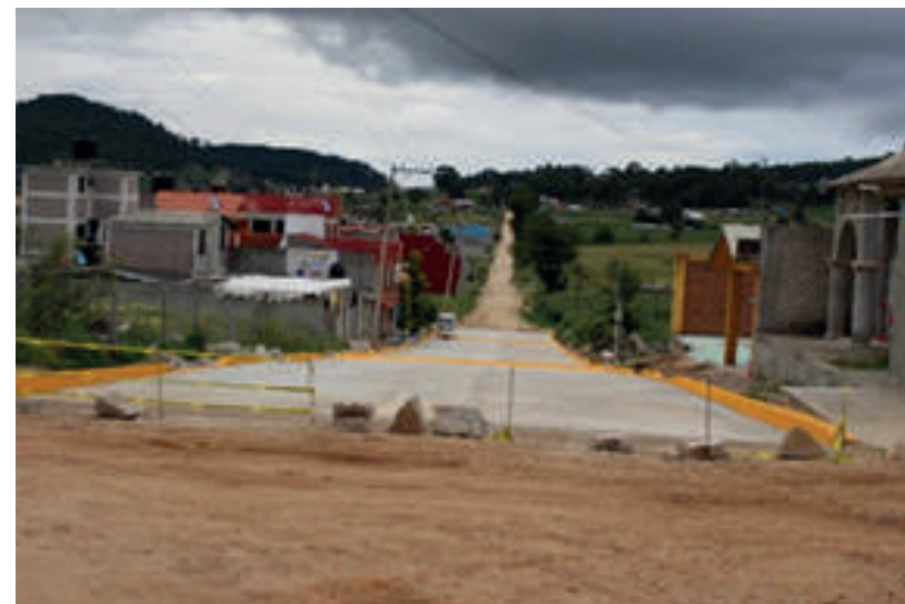
Imagen 24. foto del pueblo, diferencia de tonos entre la terracería y el concreto.
