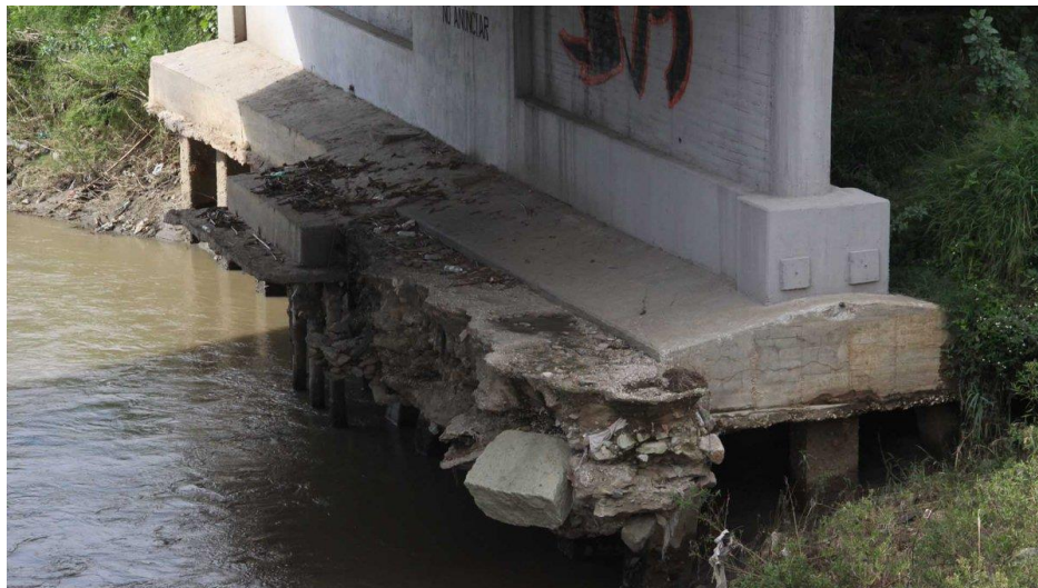
Fig. 29: Socavación en puente.
