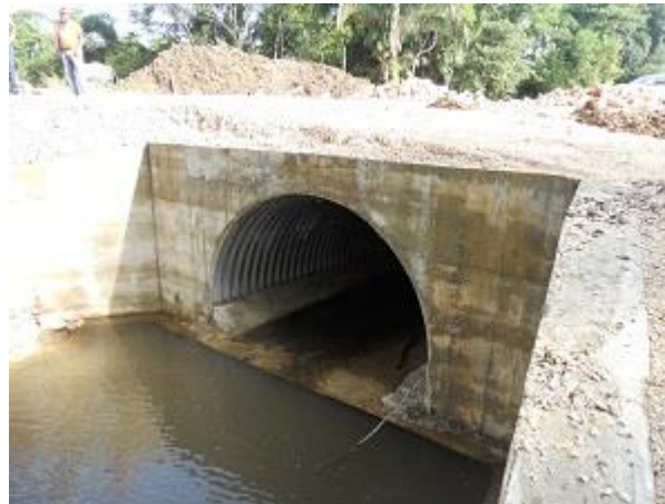
Fig. 17: Ejemplo de alcantarilla en obra.
