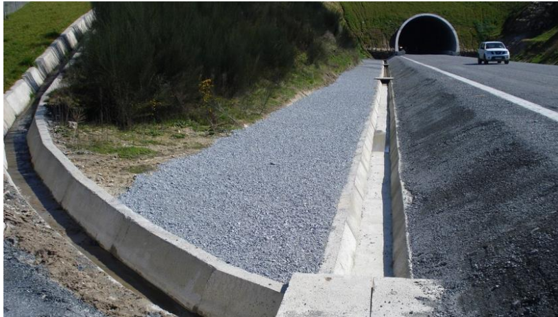
Fig. 1: Ejemplo de obra de drenaje superficial.
