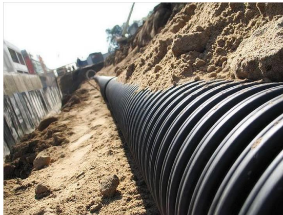
Fig. 21: Alcantarilla tipo tubo de polietileno de alta densidad.
