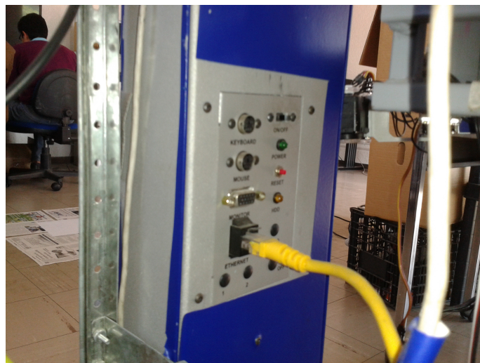
Figura 4.1: Cable de red para conectar PC a Golem.
