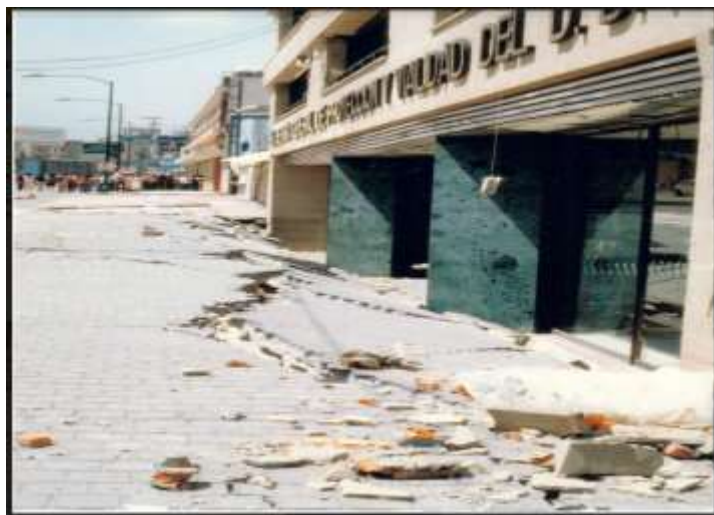
Figura 3. Hundimientos súbitos de un edificio en la Ciudad de México debido al sismo del 19 de septiembre de 1985. (fotografía tomada por el Dr. Jorge Abraham Díaz Rodríguez).
