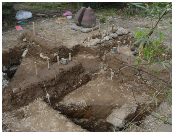
En esta imagen se aprecian los agujeros que se realizaron y como empieza a elevarse la obra.
