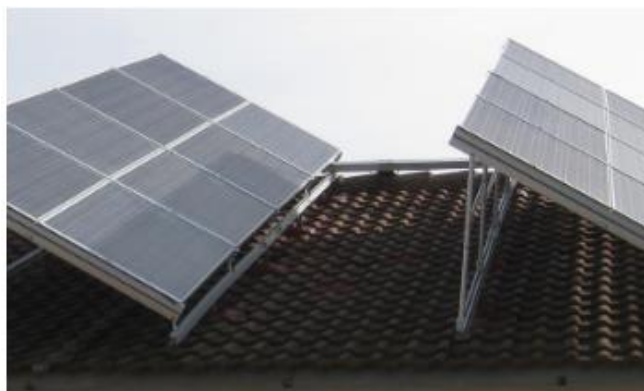
Ilustración 53 Ejemplo de sombreado de los paneles.
