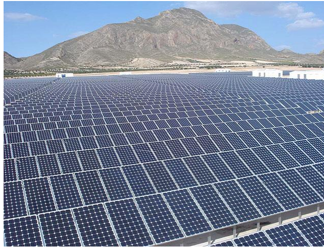
Ilustración 11 Huerto solar de CFE instalado en Durango.
