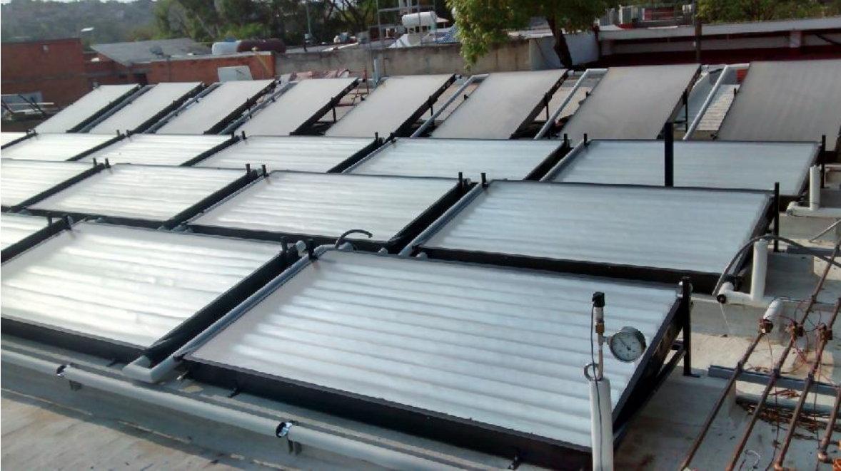
Figura 46. Banco de colectores CPC instalado en el IER-UNAM
