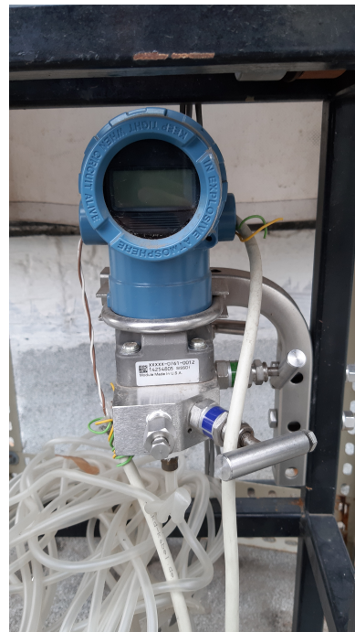
Figura 14: Fotografía del medidor de presión diferencial
