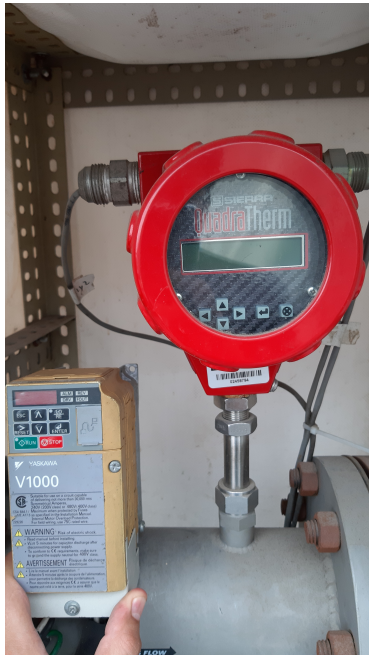
Figura 13: Fotografía del variador de frecuencia y el flujómetro
