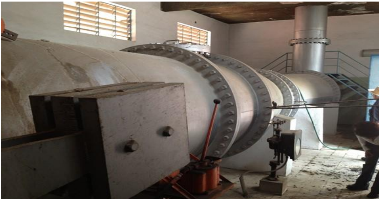
Cuarto de máquinas, Línea de alta presión. Fuente: Marco Ponce, Inspección en campo, 2018.
