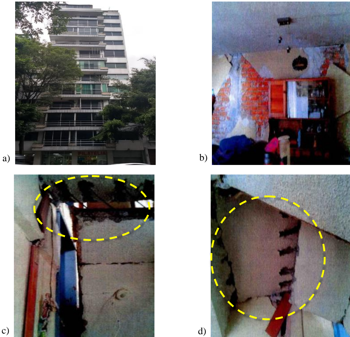
Figura 3.17. Descripción de daños en edificio CUA-245 – Riesgo Alto: a) vista exterior E-W del edificio posterior al sismo, b) daños en muros interiores con desprendimiento de acabados (2018) (Imagen obtenida de: https://bit.ly/2ZYf3hU ), c) daño en cubo de escaleras dejando expuesto el acero de refuerzo (2018) (Imagen obtenida de: https://bit.ly/2ZYf3hU ) y d) daño en las escaleras de niveles inferiores, imposibilitando su uso (2018) (Imagen obtenida de: https://bit.ly/2ZYf3hU ).
