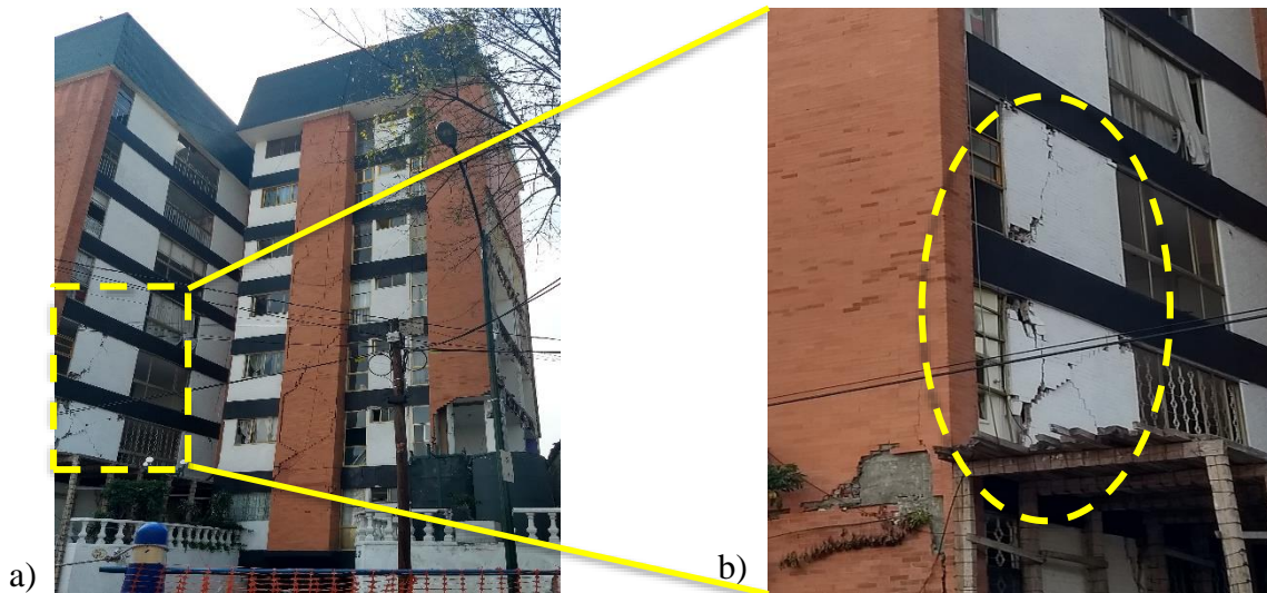
Figura 3.15. Descripción de daños en edificio BJ-57 – Riesgo Alto: a) vista exterior E-W de una de las torres del edificio posterior al sismo donde se pudo observar el daño en muros exteriores en la mayoría de sus niveles, b) detalle del daño en algunos de los muros exteriores del edificio en los que se presentaron grietas en diagonal y en forma de “X”, c) vista exterior E-W de otra de las torres del edificio en las que se
