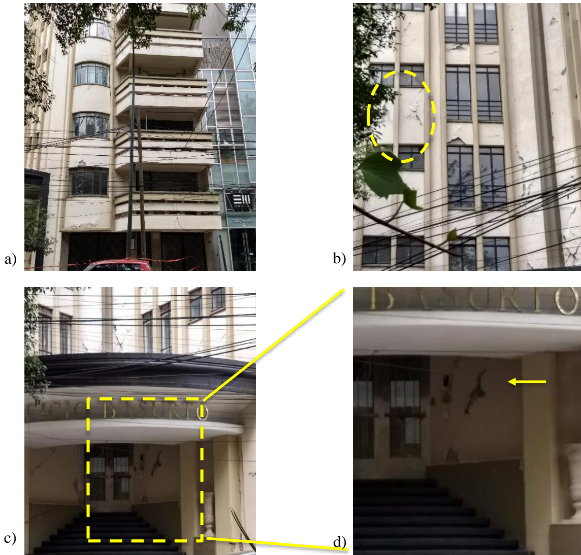
Figura 4.16. Descripción de daños en edificio CUA-136 – Riesgo Alto: a) vista frontal E-W del exterior del edificio, b) daños en muros exteriores frontales, c) daños en muros de la entrada al inmueble, d) detalle de daños en acabados en vista frontal y grietas en diagonal en muros, e) daños en muros interiores del edificio, se observan grietas a 45^\circ (2018) (Imágenes obtenidas de: https://bit.ly/2x98bkQ ), f) daños en muros interiores con grietas (2018) (Imágenes obtenidas de: https://bit.ly/2x98bkQ ), g) daños en muros interiores con grietas a 45^\circ (2018) (Imágenes obtenidas de: https://bit.ly/2x98bkQ ) y h) daños en los muros exteriores del edificio en dirección N-S (2018) (Imágenes obtenidas de: https://bit.ly/2x98bkQ ).
