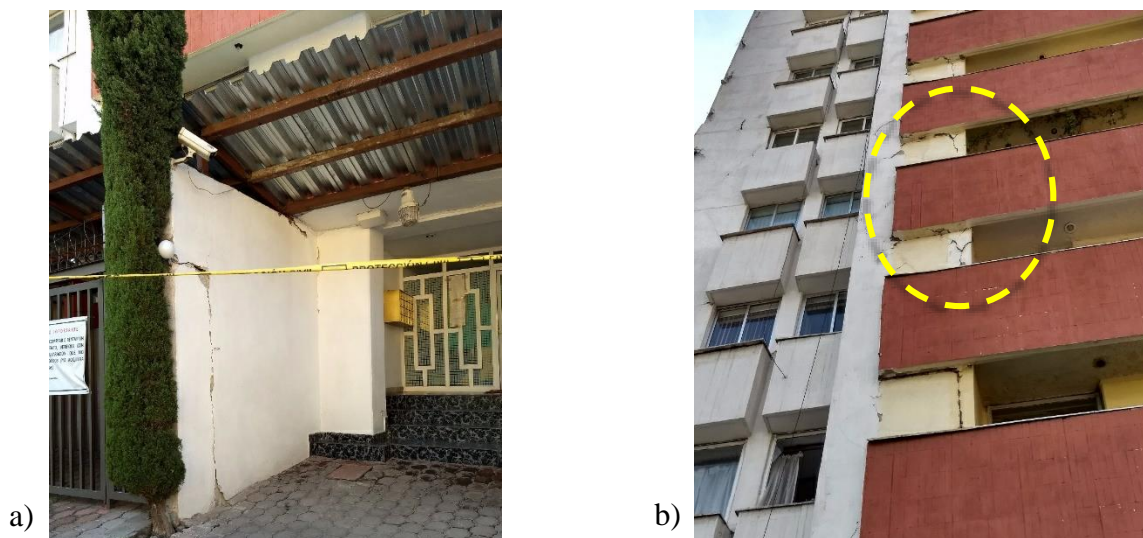
Figura 4.17. Descripción de daños en edificio BJ-42 – Riesgo Medio: a) entrada del edificio con cinta de advertencia, b) daños en muros y acabados observados en vista frontal E-W, c) daños en el interior del edificio (2018) (Imagen obtenida de: https://bit.ly/2p5aPDP ), d) daño en muro interior (2018) (Imagen obtenida de: https://bit.ly/2p5aPDP ), e) daños en acabados en vista lateral del edificio dirección N-S, f) daño en columna y desprendimiento del acabado (2018) Imagen obtenida de: https://bit.ly/2p5aPDP ), g) desprendimiento del acabado en muro al interior del edificio (2018) (Imagen obtenida de: https://bit.ly/2p5aPDP ), h) daños en muros de torre contigua, i) colocación de contraventeos entre las dos torres, vista N-S y j) visualización de colocación de acero de refuerzo en la planta baja, dirección E-W.
