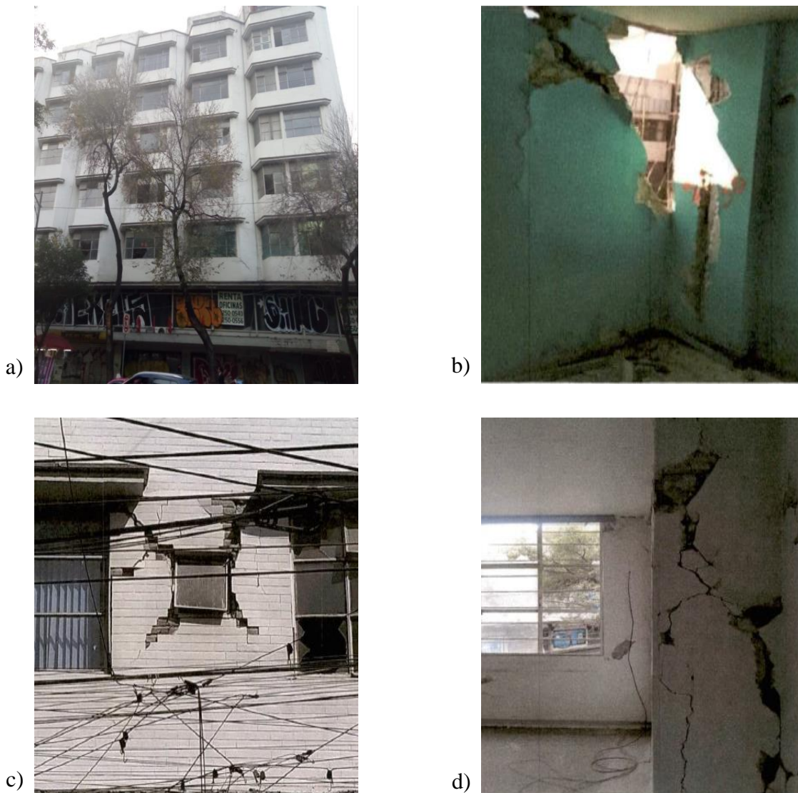
Figura 3.21. Descripción de daños en edificio CUA-94 – Riesgo Alto de Colapso: a) vista exterior E-W del edificio posterior al sismo, b) vista de uno de los departamentos donde se pudo observar el colapso parcial de un muro (2018) (Imagen obtenida de: https://bit.ly/2ZYf3hU ), c) grietas en diagonal observables desde el exterior en vista N-S del inmueble (2018) (Imagen obtenida de: https://bit.ly/2ZYf3hU ) y d) grietas en muros interiores del edificio (2018) (Imagen obtenida de: https://bit.ly/2ZYf3hU ).
