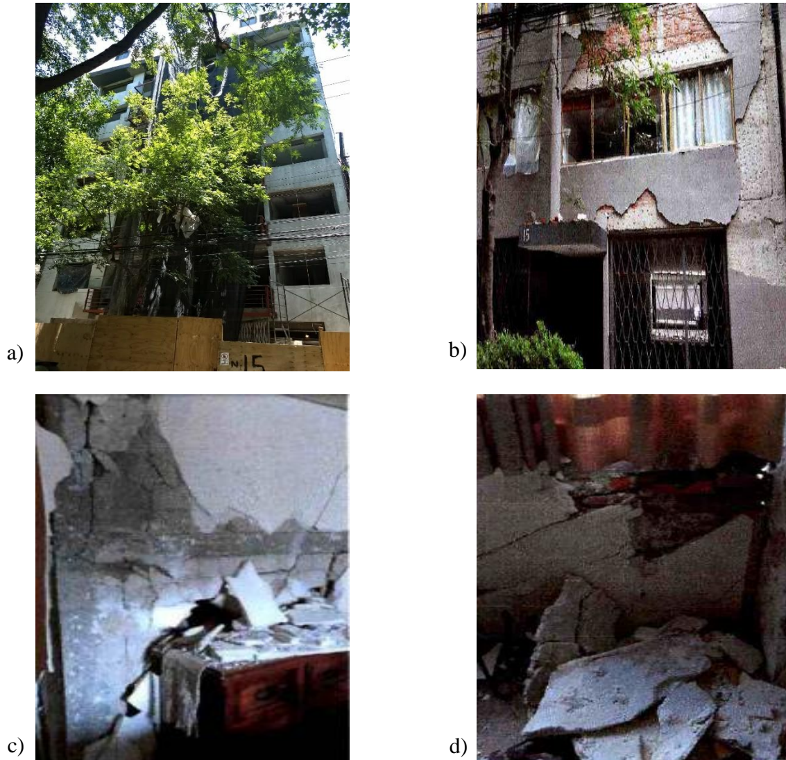
Figura 4.13. Descripción de daños en edificio CUA-22 – Riesgo Alto: a) vista exterior N-S del edificio posterior al sismo, b) vista N-S de la fachada del edificio posterior al sismo y previo a trabajos de obra donde se observa el desprendimiento del acabado (2018) (Imagen obtenida de: https://bit.ly/2NH2Iva ), c) daño en muro interior de uno de los departamentos del edificio (2018) (Imagen obtenida de: https://bit.ly/2NH2Iva ), d) daño en muro de ventana (2018) (Imagen obtenida de: https://bit.ly/2NH2Iva ), e) grieta en muro interior (2018) (Imagen obtenida de: https://bit.ly/2NH2Iva ), f) grieta en muro interior y desprendimiento del acabado (2018) (Imagen obtenida de: https://bit.ly/2NH2Iva ), g) daño en muros y acabados (2018) (Imagen obtenida de: https://bit.ly/2NH2Iva ), h) daños observados en columnas desde el interior (2018) (Imagen obtenida de: https://bit.ly/2NH2Iva ), i) daño en muro interior y en columna donde se puede observar el acero de refuerzo (2018) (Imagen obtenida de: https://bit.ly/2NH2Iva ) y j) daño en columna donde se observa el acero de refuerzo (2018) (Imagen obtenida de: https://bit.ly/2NH2Iva ).
