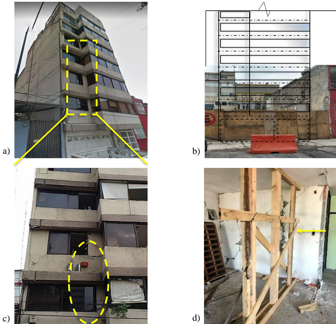
Figura 4.20. Descripción de daños en edificio CUA-142 – Demolición: a) Vista frontal E-W del edificio antes del sismo, b) Vista actual después del sismo y posterior a la demolición, c) Daños en columnas y ventanas rotas observados en la vista frontal, previo a la demolición. (Colonia Roma Sur. (24, septiembre, 2017). ¡Vecinos mucha PRECAUCIÓN! Edificio Nautla XX. Con daño estructural ya catalogado para derribar. [Tuit]. Recuperado de: https://bit.ly/2OwFmVJ ) y d) Daños en el interior del edificio después del sismo y previo a la demolición, se observa apuntalamiento. (Obras CDMX. (30, mayo, 2018). En Nautla
