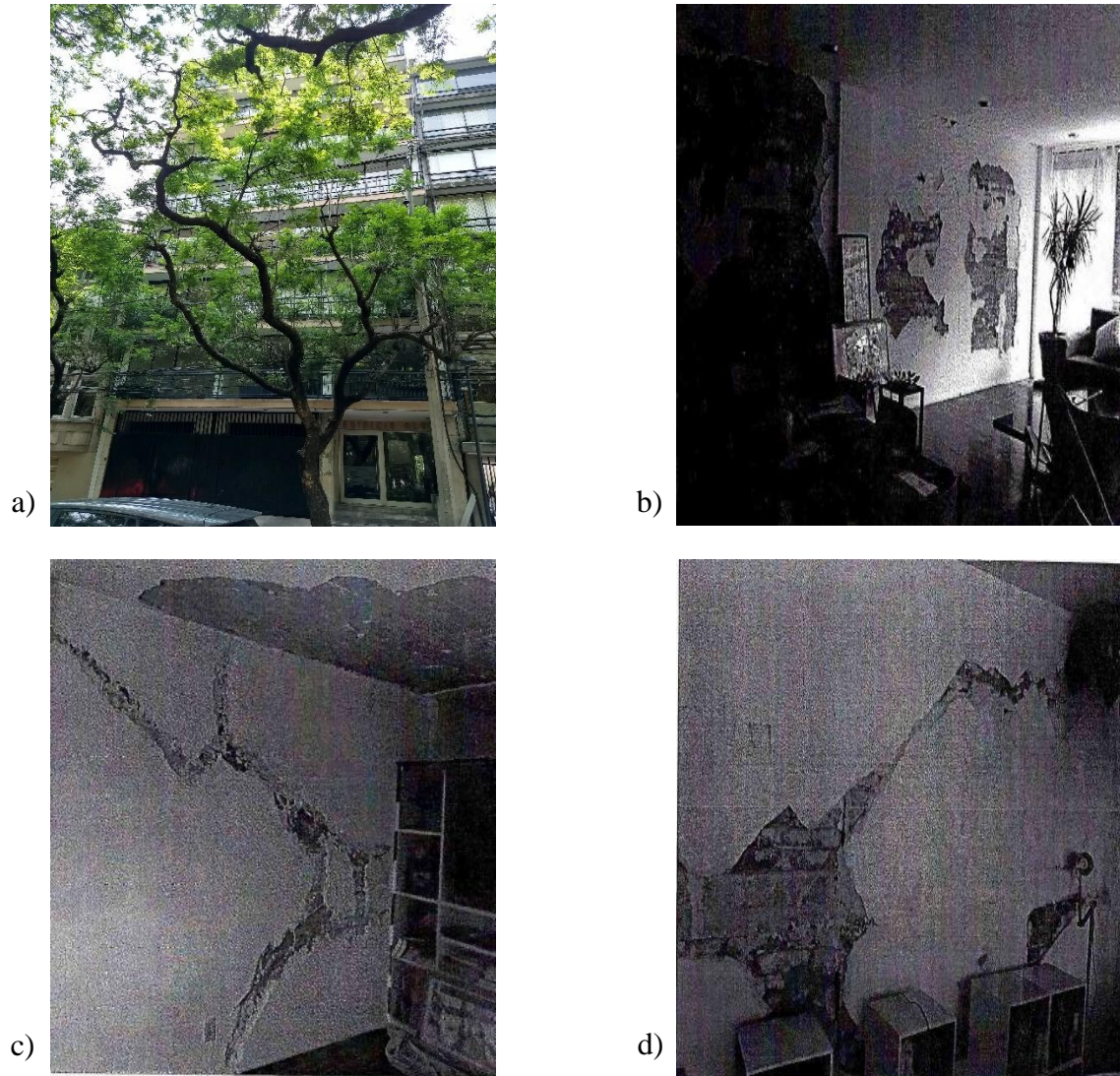
Figura 4.15. Descripción de daños en edificio CUA-135 – Riesgo Alto: a) vista exterior E-W del edificio posterior al sismo, b), desprendimiento de acabados en muro longitudinal en colindancia norte, c) fisuras en muros de colindancia norte en uno de los departamentos (2018) (Imagen obtenida de: https://bit.ly/2CUlpHB ), d) grietas a 45° en muros divisorios (2018) (Imagen obtenida de: https://bit.ly/2CUlpHB ), e) columna de concreto dañada por golpeteo de edificio contiguo (2018) (Imagen obtenida de: https://bit.ly/2CUlpHB ) y f) desprendimiento de recubrimiento en columna de concreto debido a golpeteo del edificio colindante (2018) (Imagen obtenida de: https://bit.ly/2CUlpHB ).
