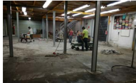
Fig.80 - Mejoras en el área de control de calidad, 2017.
