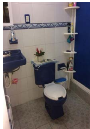
Fig. 142 - En esta imagen se puede ver un baño con instalaciones básicas de inodoro y lavabo, sin embargo, esta instalación cuenta con cancelos que dividen el espacio de la regadera.
