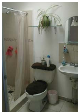
Fig. 140 - El primer espacio de baño es una instalación básica con lavabo, inodoro y regadera con cortina de baño.
