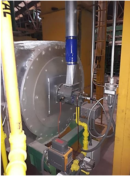
Fig. 33 Quemador instalado en la cámara de combustión
