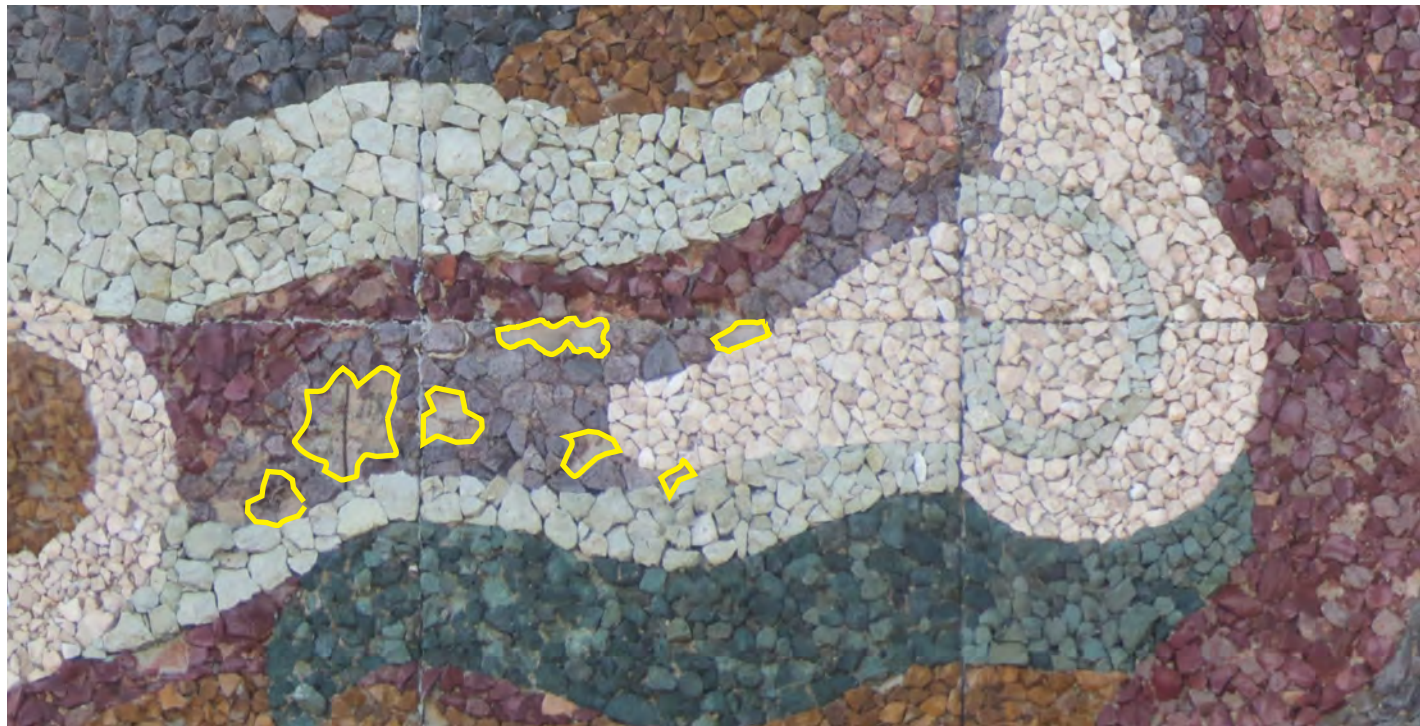
Detalle de la pérdida de material pétreo en los paneles que componen el mural. Sep-Dic. 2012. Crédito: Virginia Arroyo Rodríguez.
