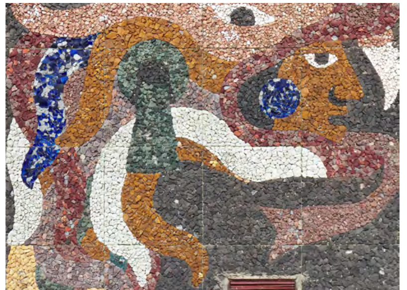
El empleo de materiales con características diferentes a las originales, causan el efecto de “manchas” donde se altera de manera significativa la lectura original del mural. Sep-Dic. 2012. Crédito: Virginia Arroyo Rodríguez.
