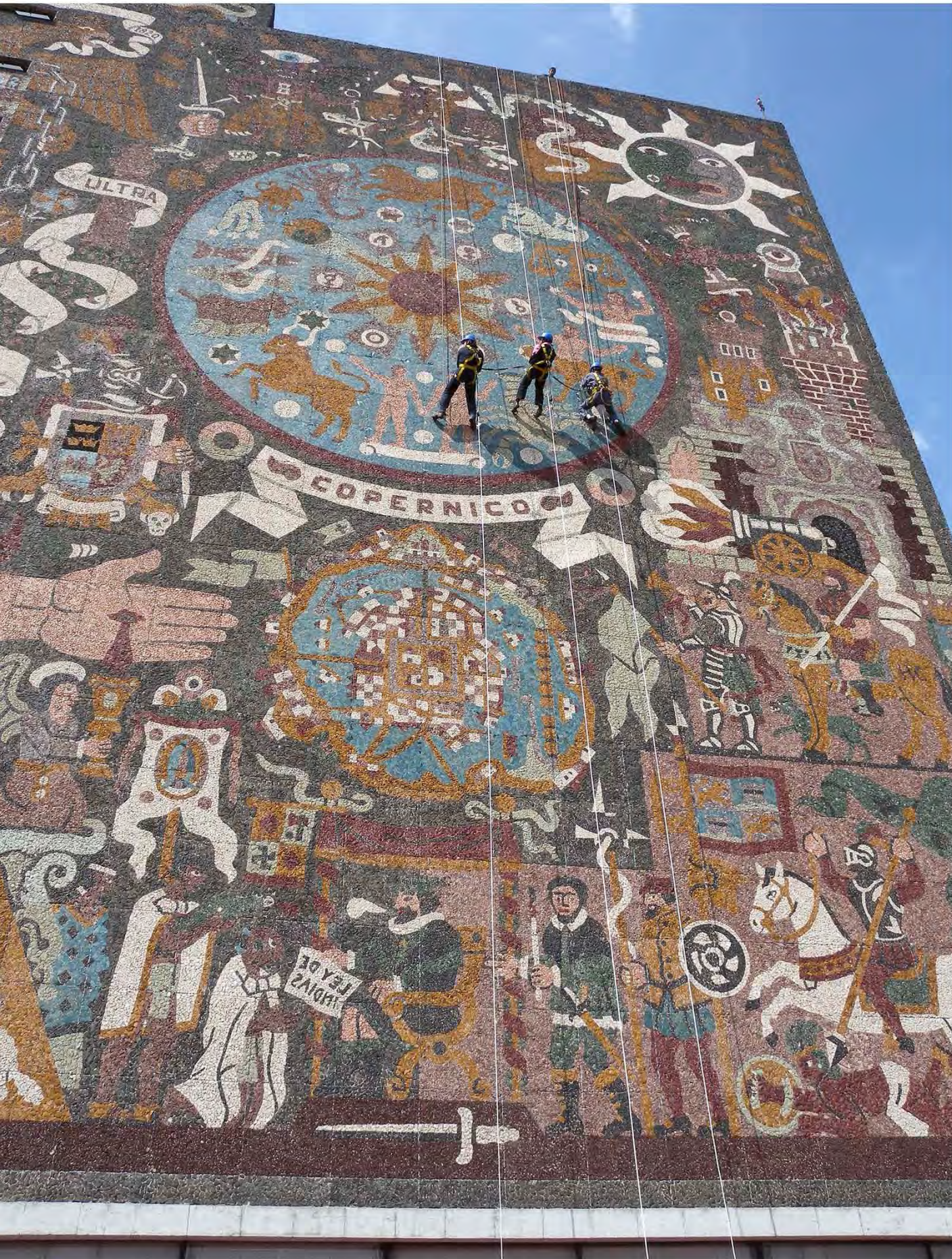
Diagnóstico a rapel sobre la fachada sur. Sep-Dic. 2012. Crédito: Virginia Arroyo Rodríguez.
