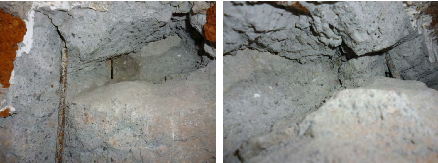
Detalle de la capa de concreto de aproximadamente cinco centímetros , que se colaba una vez que el panel se encontraba colocado en su sitio. Sep-Dic. 2012. Crédito: Virginia Arroyo Rodríguez.
