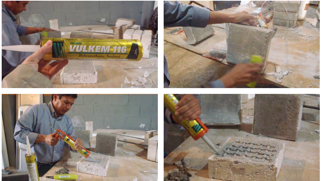
Preparación y aplicación del producto de EUCLID sobre las muestras preparadas para la realización de las pruebas en el Instituto de Ingeniería. Sep-Dic 2012 Crédito: Virginia Arroyo Rodríguez.
