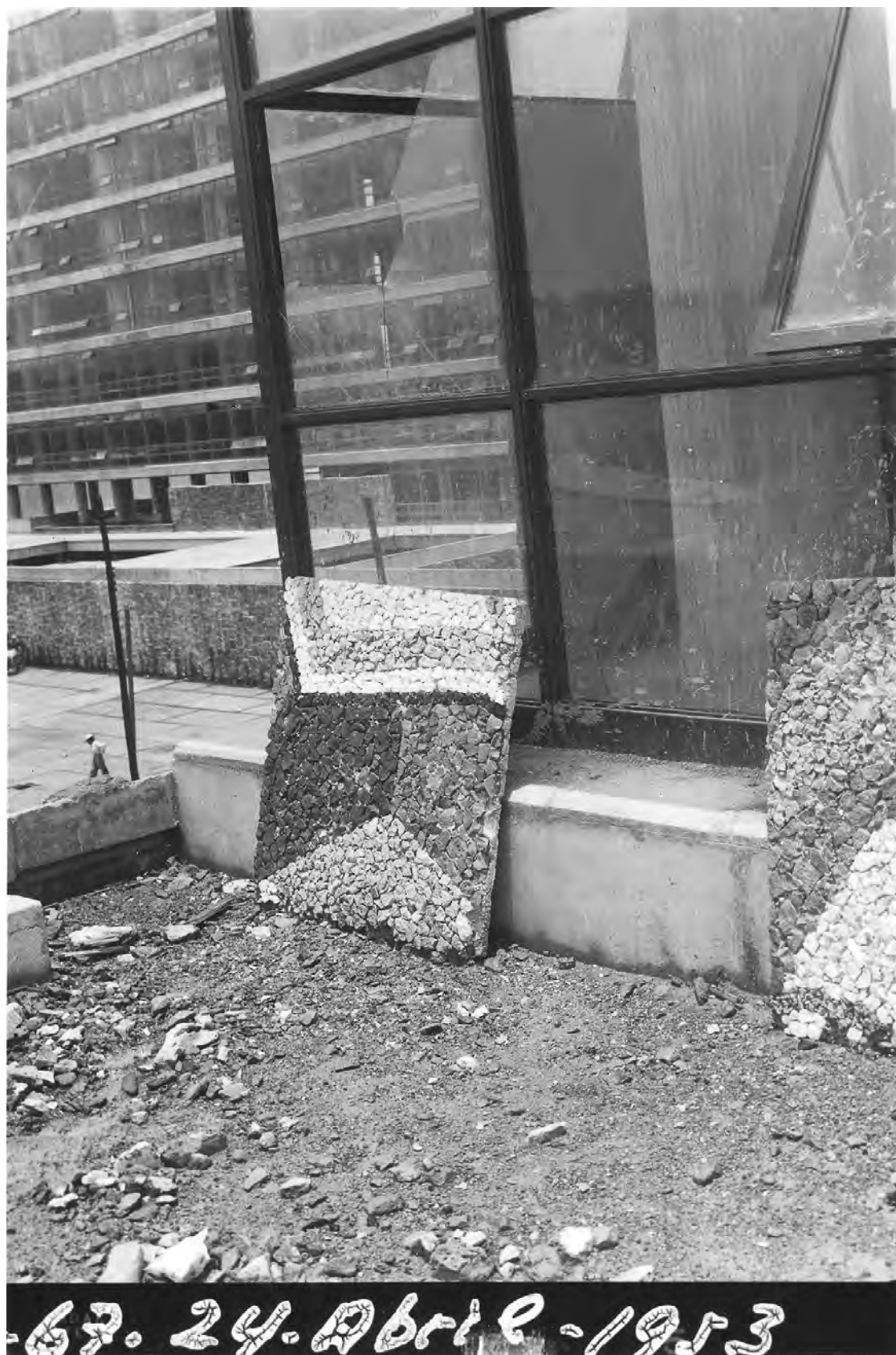
Acercamiento vertical, de las placas del mural de la Biblioteca Central. En el margen izquierdo, fuera de la imagen, la leyenda "P-67-24-abril-1953"; en el reverso las inscripciones manuscritas "BIBLIOTECA. P. 67.- AVANCE DE LA OBRA. PLACAS MURAL". S/a. Imagen obtenida en: IISUE/AHUNAM/Colección Universidad, Sección: Construcción de C.U./3455.
