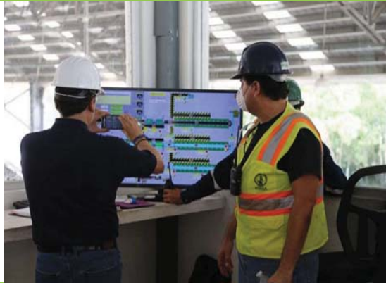
Imagen 91. Módulo de supervisión.
