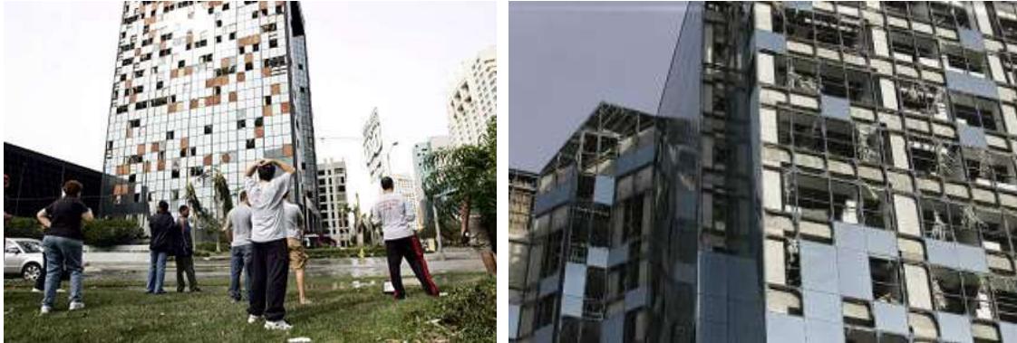
Figura 5 Daños en ventanas por la acción del viento (Pulmig, 2018)
