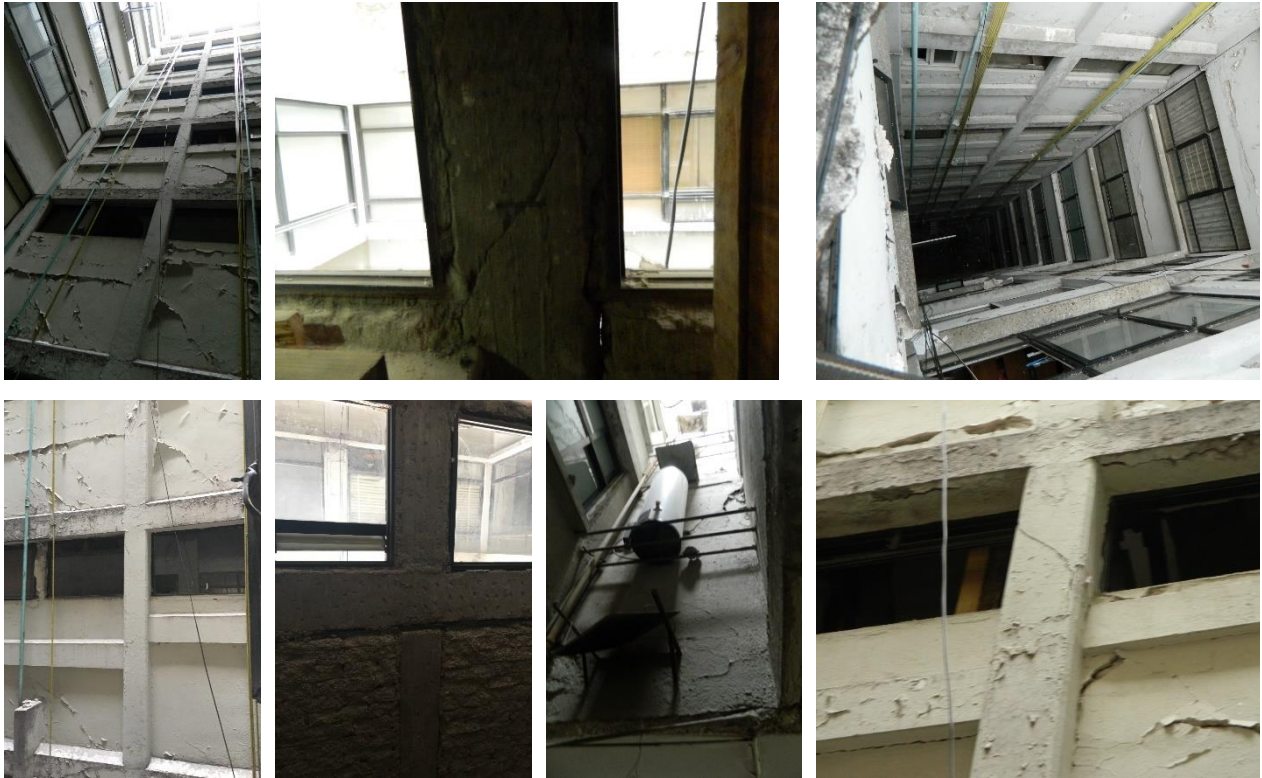
Cubo de escaleras Observese daños estructurales en columna
