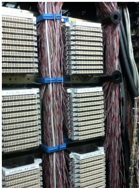
Imagen 6. Regletas telefónicas, cuarto de telecomunicaciones DGTIC.
