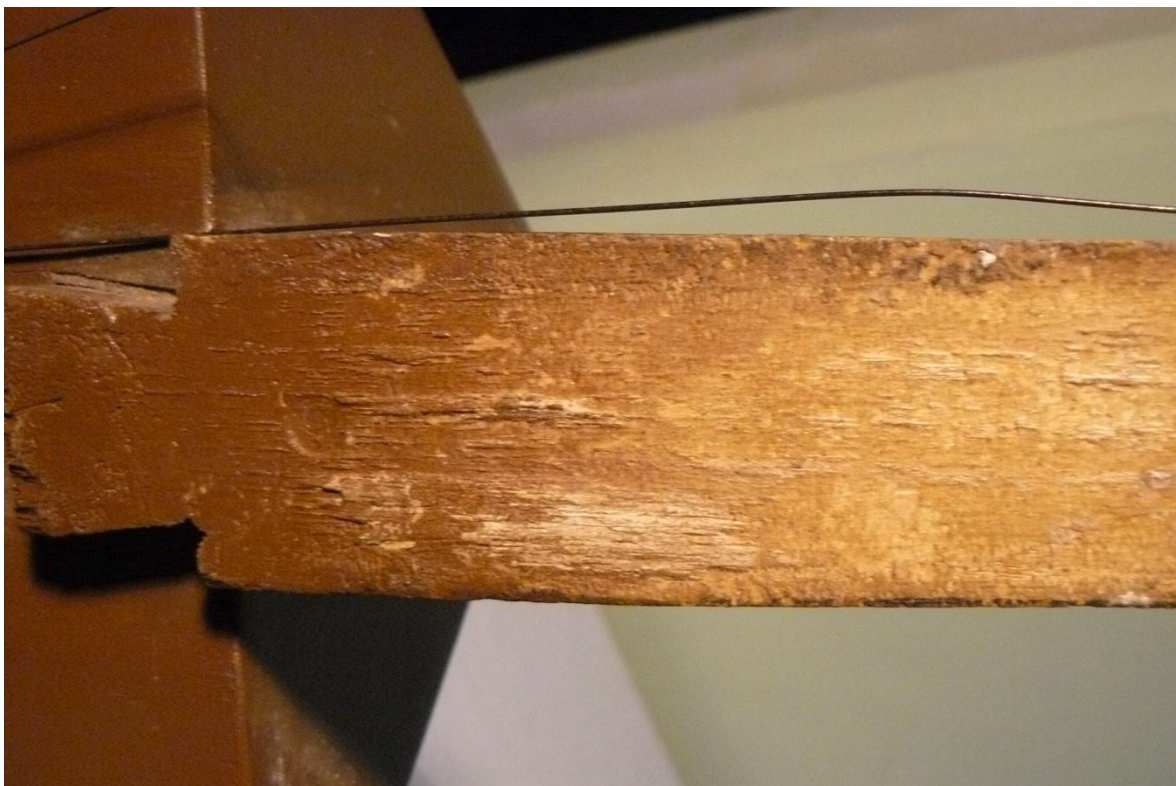
Imagen 3.14. Brazo con serios daños. Fotografía de Javier Alanís.
