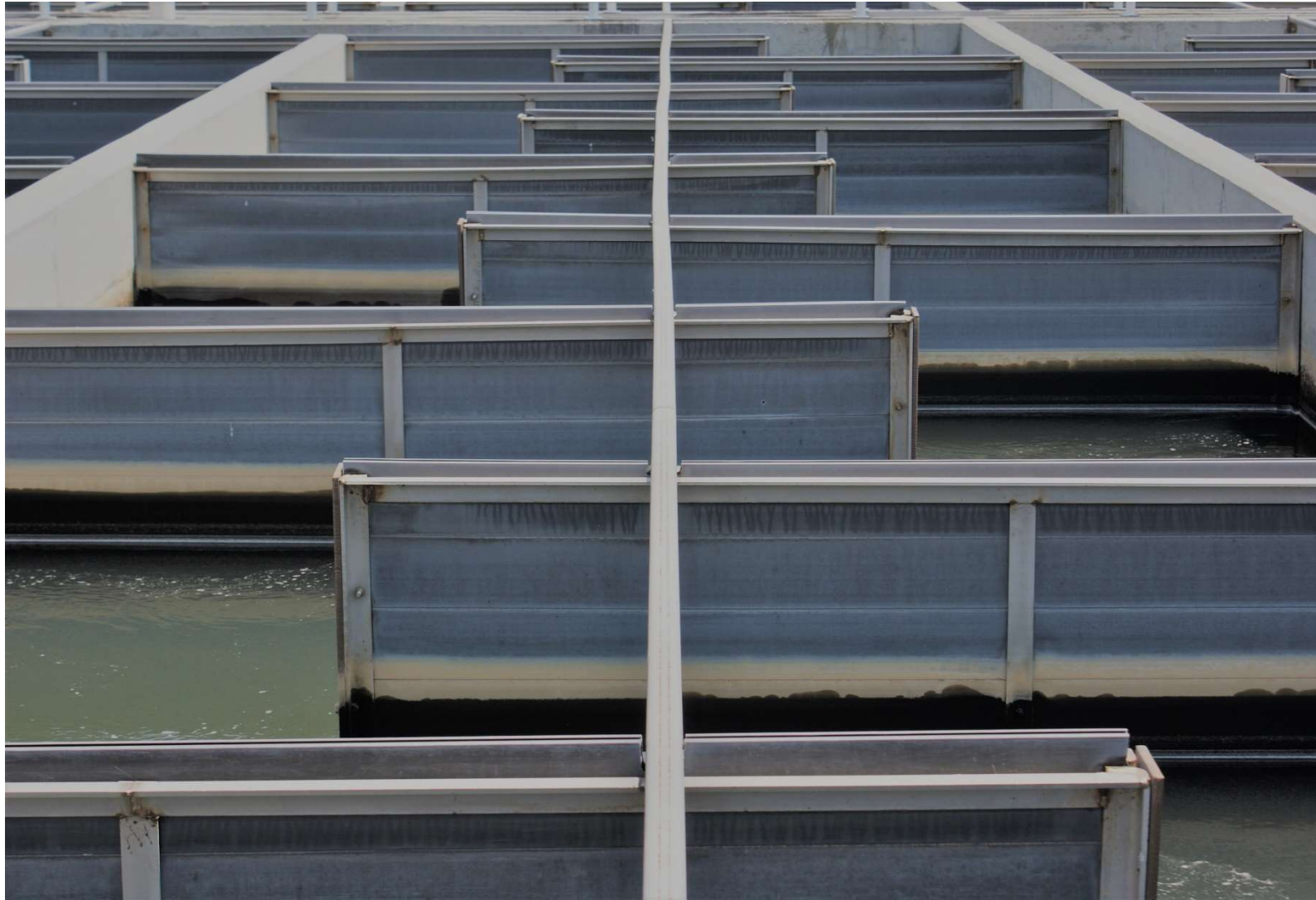
Fotografía: Floculación. PTAR Los Berros, Sistemas Cutzamala, Estado de México, México
