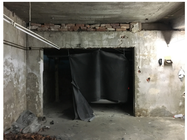
Il. 54, 55, 56: Soluciones improvisadas que se implementaron para la problemática del peso que se encuentra en planta alta, producto de la instalación de maquinaria en un área que originalmente era una casa habitación. Fotografía de Esaúl Hernández (2017 y 2018)
