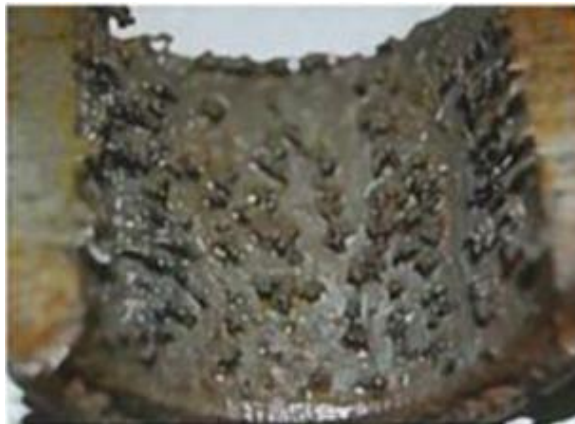
Figura 3.4 Corrosión por CO 2 (Martin, y otros, 2016).
