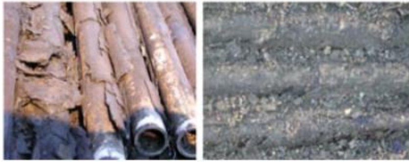
Figura 1.2 Corrosión por sulfhídrico a alta temperatura (Groysman, 2017).
