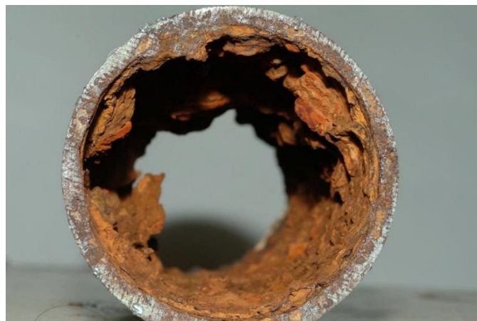
Figura 1.10 MIC en la superficie interna de una tubería.
