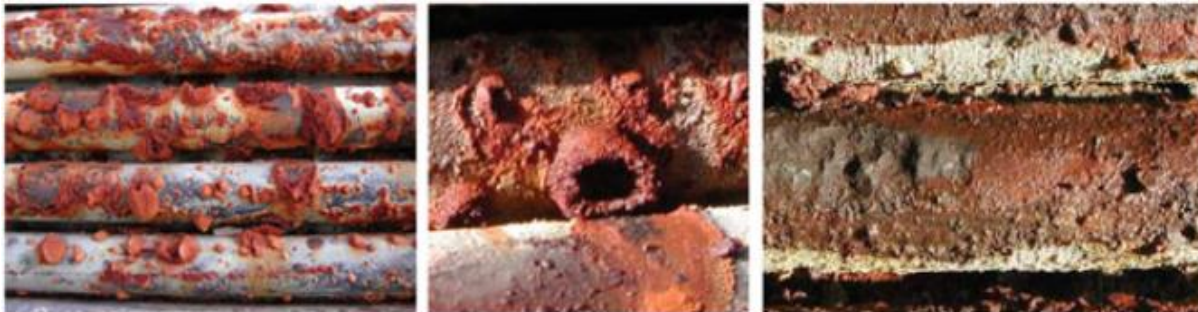
Figura 1.5 Corrosión por bacterias en tubo de planta petroquímica (Groysman, 2017).
