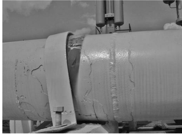
Figura 1.9 Corrosión por grietas debajo de la correa de restricción de una tubería (Lund, Enning, & Lee, 2017).
