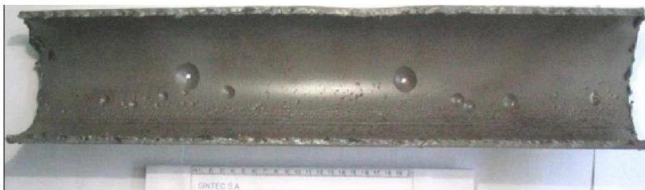
Figura 1.8 Corrosión por picadura en una línea de producción (Pan American Energy, 2007).
