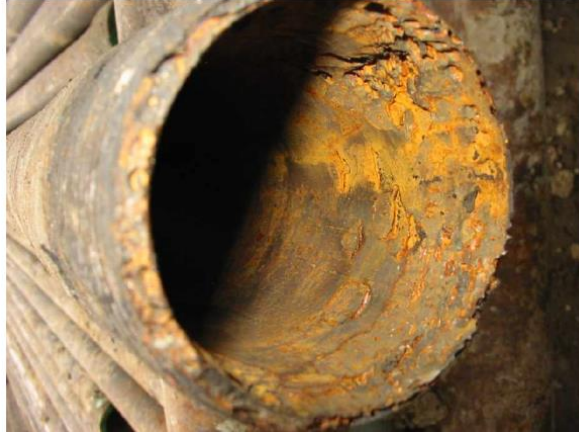
Figura 1.11 Erosión corrosión por CO 2 en una TP (Pan American Energy, 2007).
